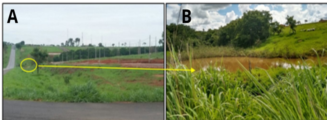
Foto 22 A e B – Impactos em APP de Nascente decorrente de implantação de Loteamento – margem da Rodovia 330 - Catalão a Goiânia, em 2015
