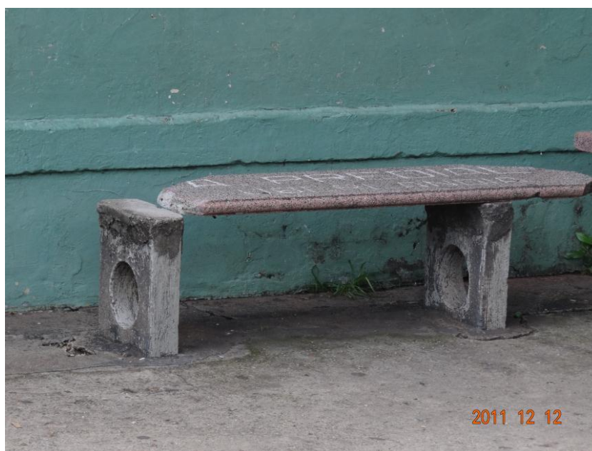
Figura 10 - Banco quebrado. Fonte: Fotografia de Maíra Scarpellini.
