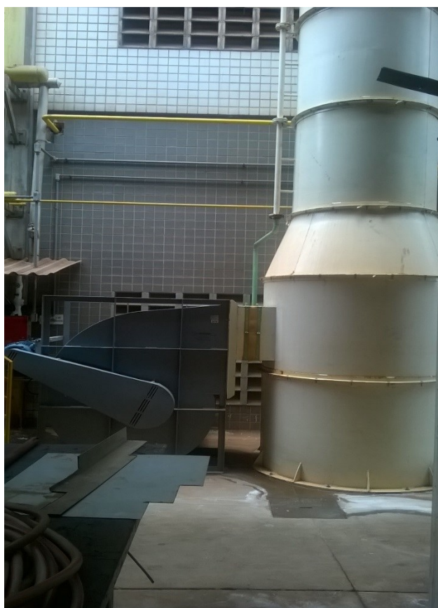
Figura 10-Lavador de Gás (Autor)
