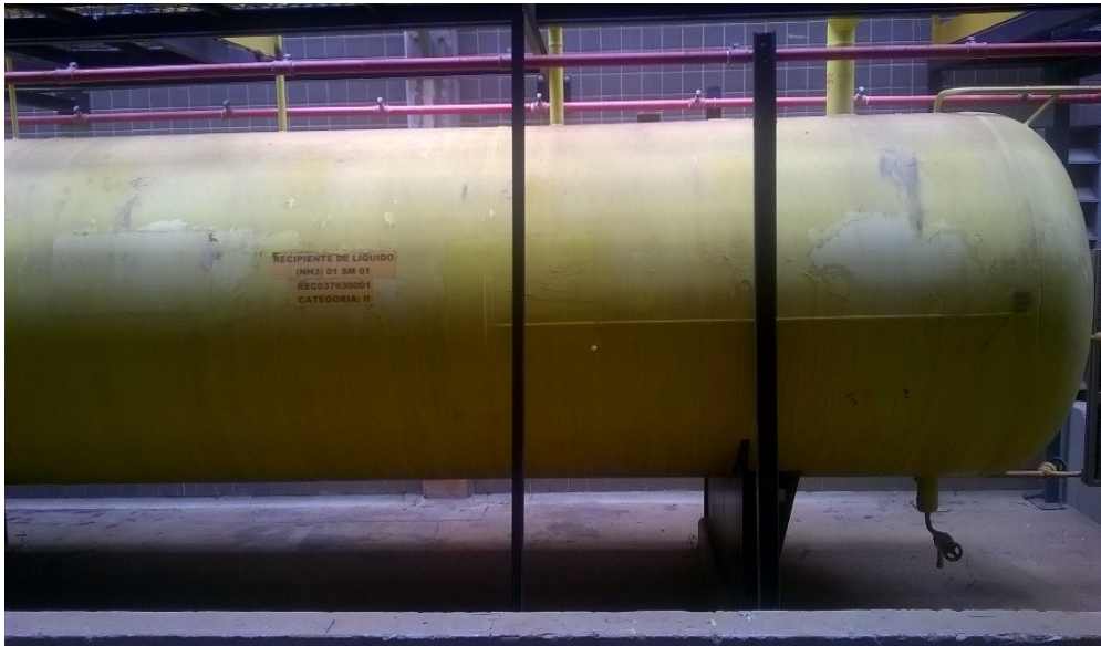
Figura 14-Reservatório de Amônia.
