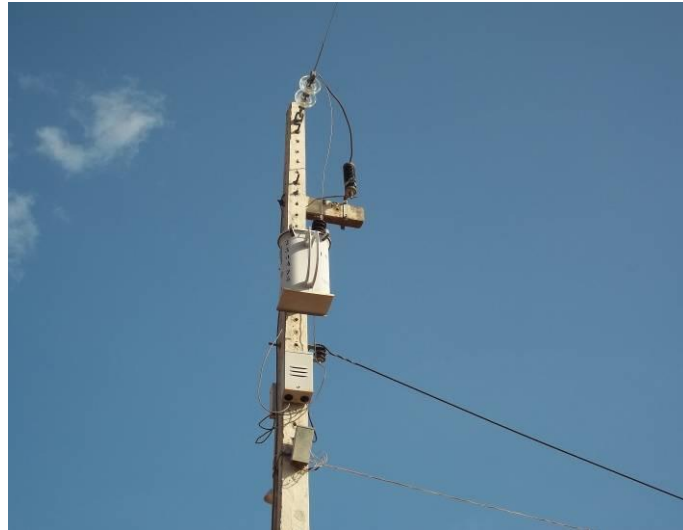
Figura 2.6 – Posto de transformação em uma linha de distribuição rural – Sistema MRT.
