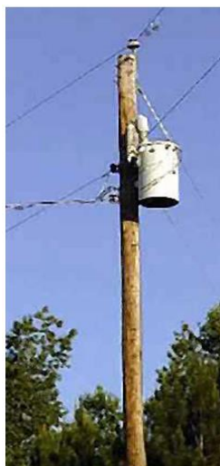
Figura 2.3 – Posto de transformação monofásico – linha de distribuição rural de 13,8 kV.
