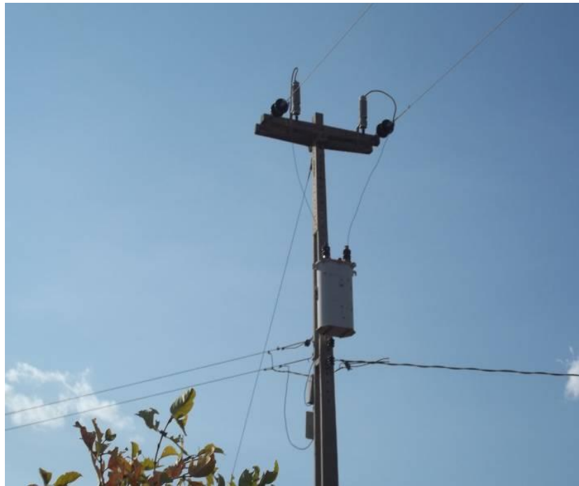
Figura 2.2 – Posto de transformação bifásico em uma rede de distribuição rural.
