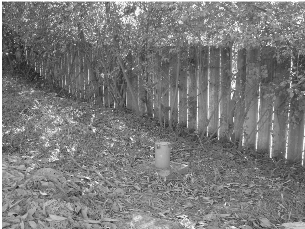
Figura 17: Poço de monitoramento de águas subterrâneas no aterro sanitário de Belo Horizonte.
