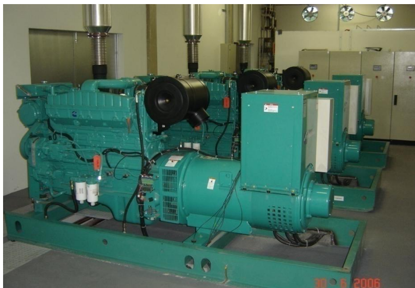
Figura 1.1 Usina geradora de 2MVA instalada na Sherwin Willians
