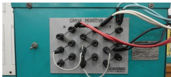
Figura 6.9 Quadro com Resistências
