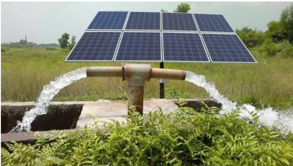
Figura 4: Exemplo de sistema fotovoltaico isolado não doméstico para bombeamento solar
