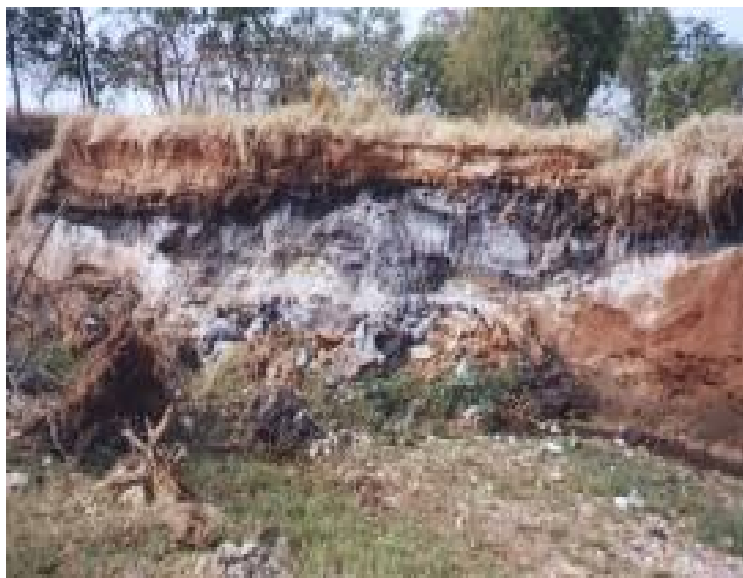
FIGURA 7.13 – Queda de Talude, devido ao impacto das águas pluviais. Data: 16/09/2004.
