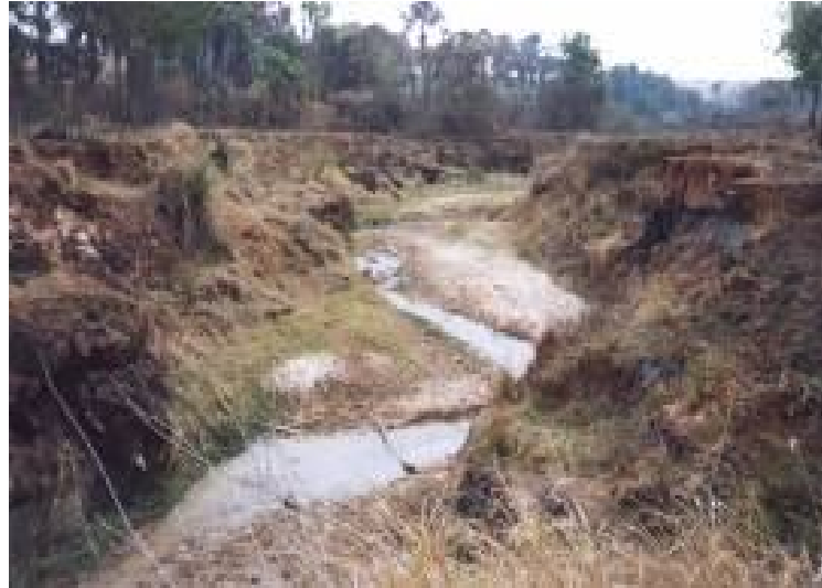
FIGURA 7.11 – Escavação do leito do córrego devido ao impacto das águas pluviais. Data: 16/09/2004.
