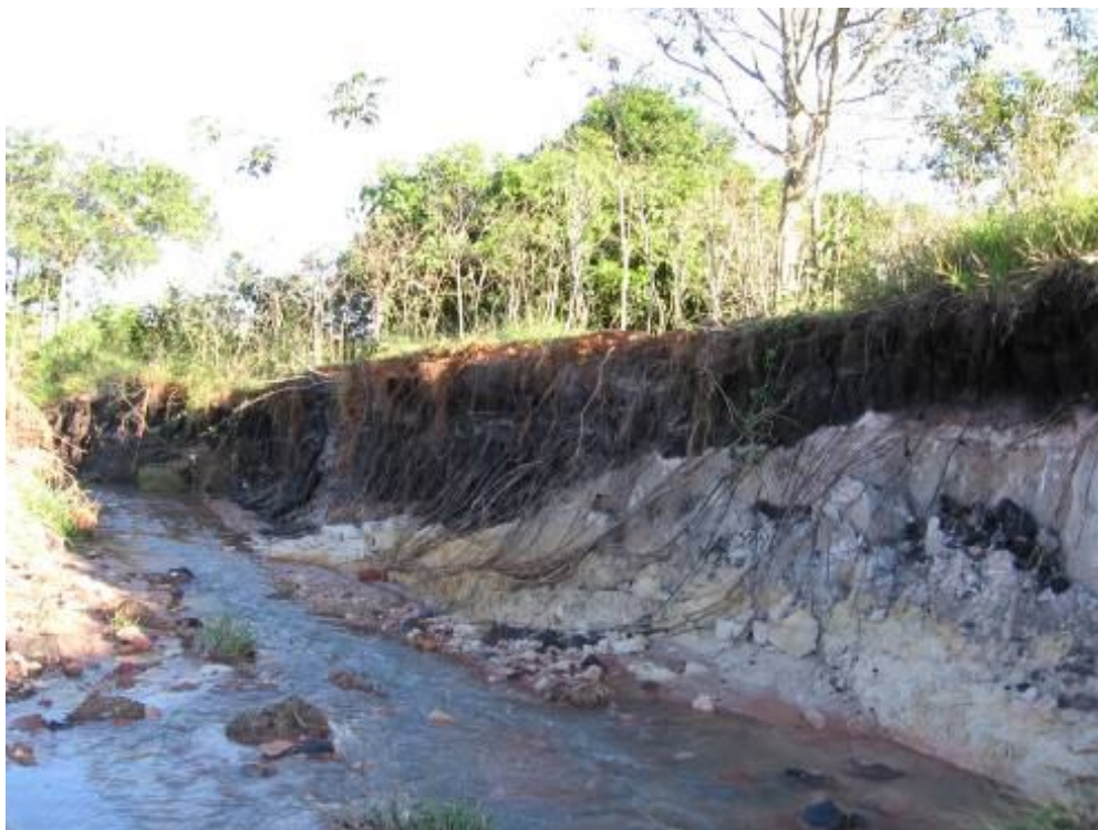
FIGURA 6.12 – Erosão nas margens do córrego. Data: 13 de fevereiro de 2005.
