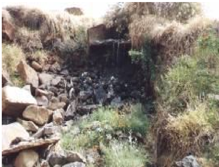
FIGURA 7.3 – Despejo de águas pluviais e esgoto na cabeceira do córrego. Data: 16/09/2004.
