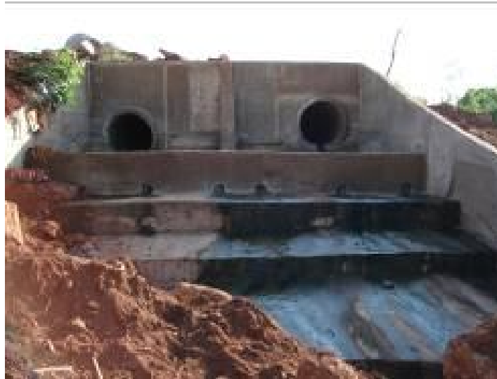
FIGURA 7.4 – Despejo de águas pluviais e esgoto na cabeceira do córrego. Data: 05/04/2007.
