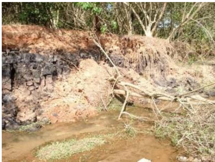
FIGURA 7.22 – Queda de vegetação. Data: 22/07/2007.
