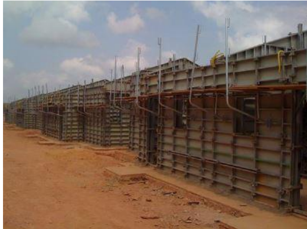
Figura 3 – Sistema de fôrmas utilizado pela Gethal Fonte: Gethal (2016)
