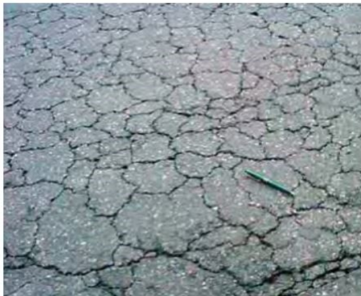
Figura 4 - Trinca por fadiga.
