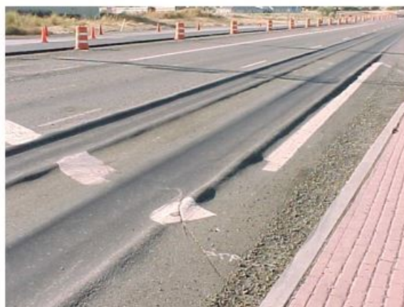
Figura 5 – Exemplo de afundamento em trilha de roda por deformação cisalhante.
