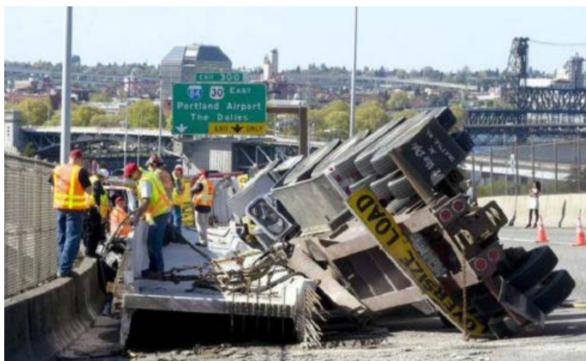
Figura 1.6 – Acidente durante o transporte de viga pré-moldada em Oregon, EUA.
