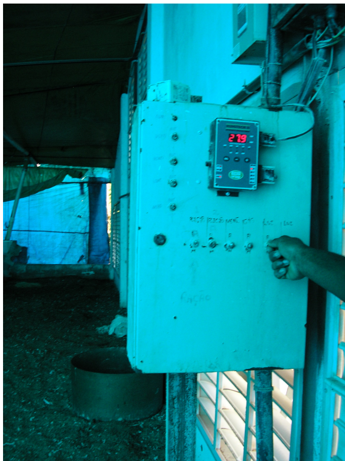
Foto 1: máquina responsável pelo aquecimento dos barracões Fonte: Arquivo pessoal
