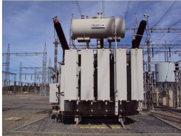
Figura 2.9 – Reator Linear de uma subestação da Eletronorte em Cuiabá – MT.
