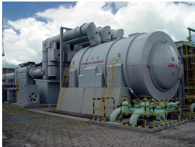
Figura 2.11 – Foto de um compensador síncrono instalado em uma subestação no estado do Maranhão.
