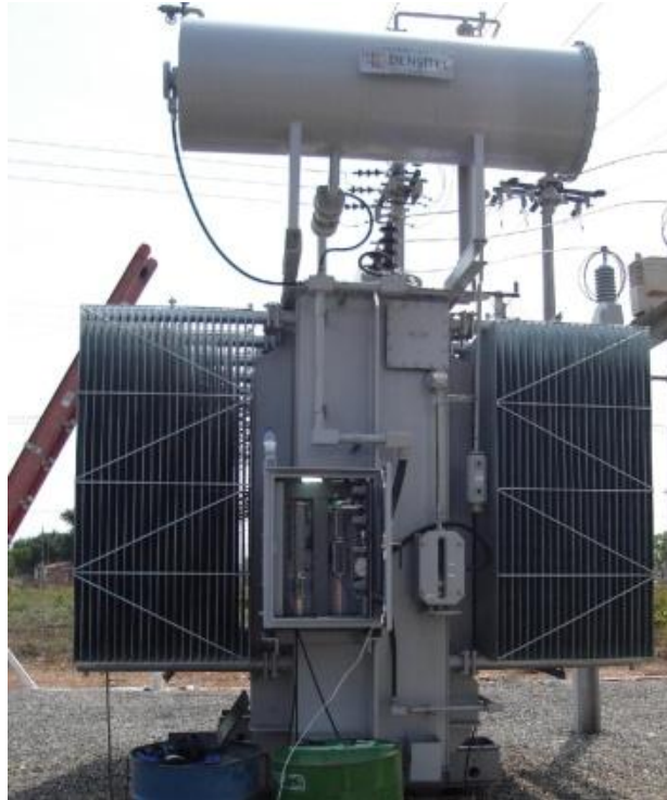
Figura 2.13 –Reator a Núcleo Saturado de 3MVA r e 34,5 kV.
