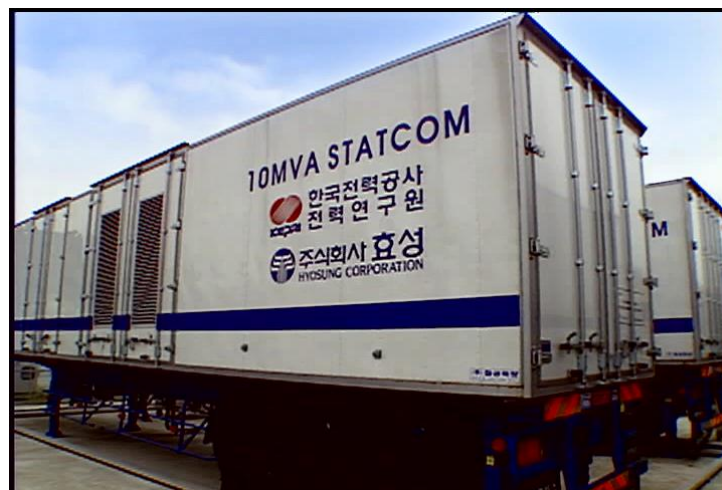
Figura 2.19 – Container contendo a estrutura do STATCOM
