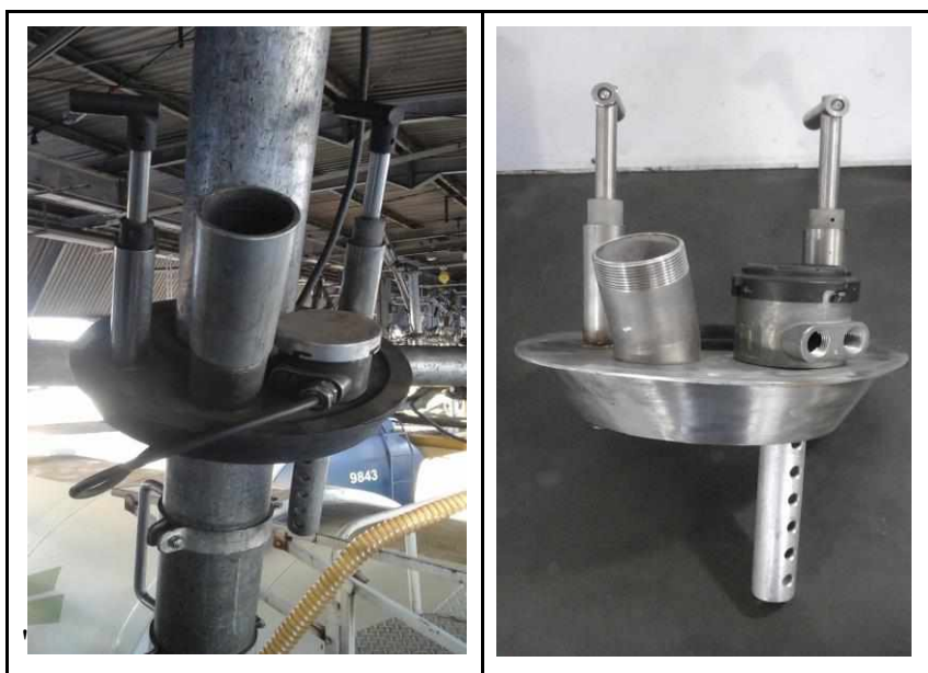
Figura 10 - Sistema Overflow Top-Loading (Depois)
