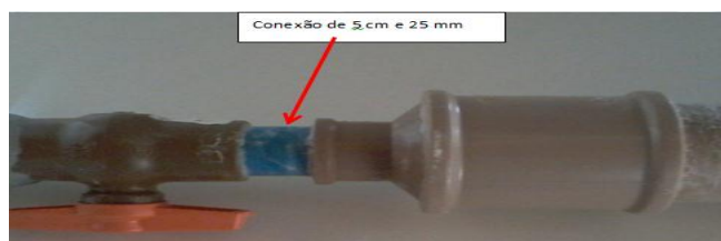
Figura 6 – Reservatório ligado ao registro por meio de tubo de 25 mm (azul) - autoria própria
