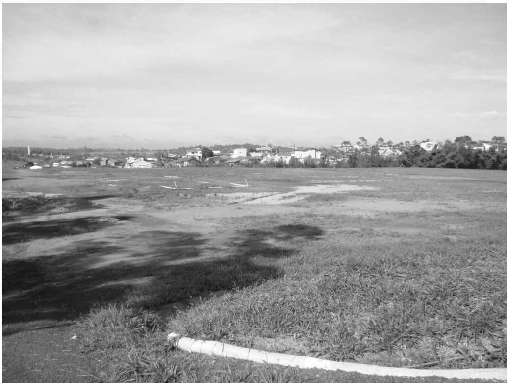
Figura 26: Empoeçamento de água pluvial e falhas na cobertura vegetal, no aterro Parque Santa Bárbara em Campinas - SP.
