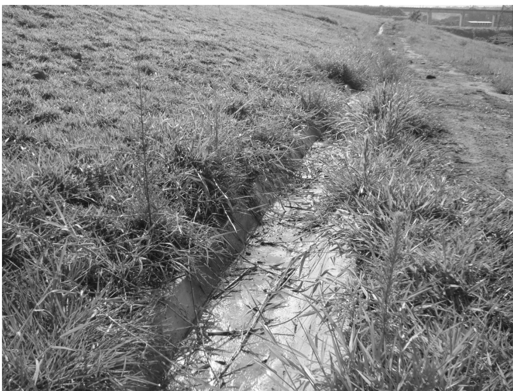
Figura 27: Obstrução da canaleta de drenagem de águas pluviais como consequência do crescimento da vegetação, aterro Parque Santa Bárbara em Campinas - SP.
