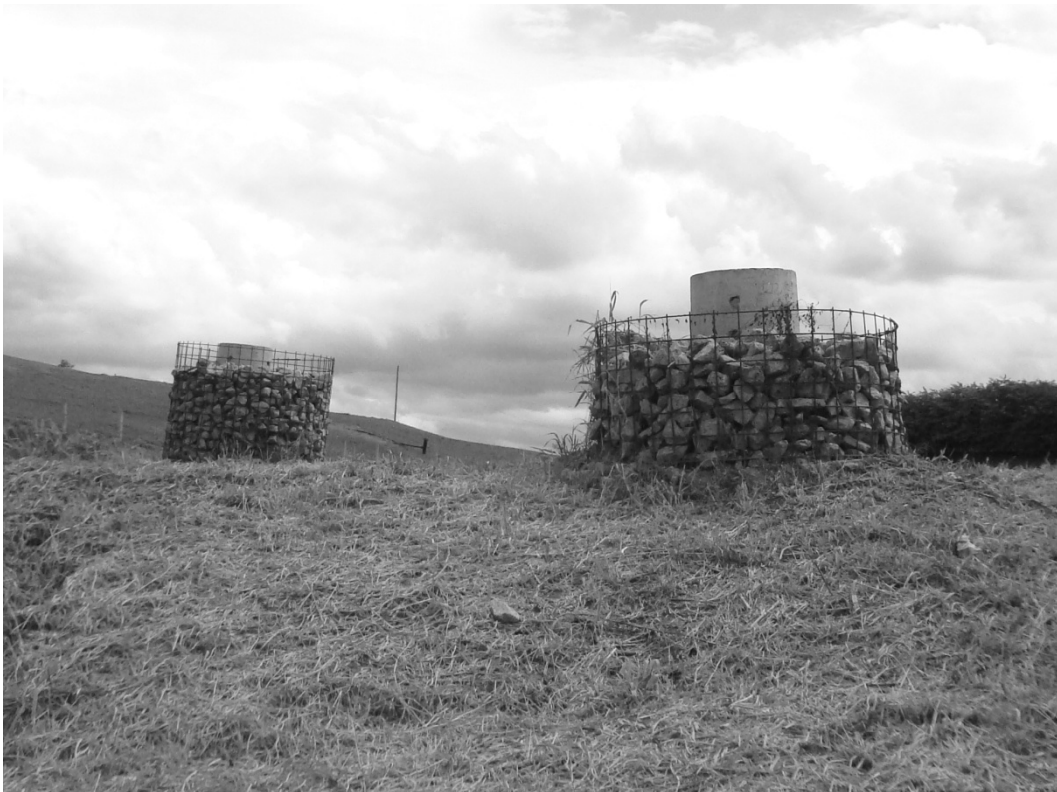
Figura 33: Dreno vertical de biogás, aterro Bandeirantes, São Paulo - SP. Fonte: A autora, 2009.
