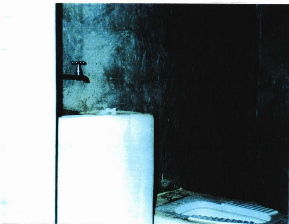
Banheiro da cela de menores. Visão da pia e do vaso sanitário. As paredes do banheiro não foram pintadas.
