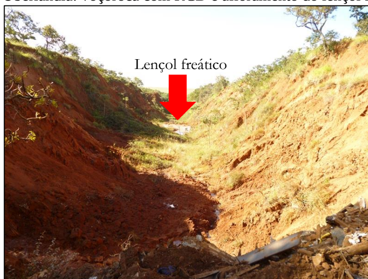
Figura 37 – Uberlândia: voçoroca com RCD e afloramento do lençol freático, 2.012
