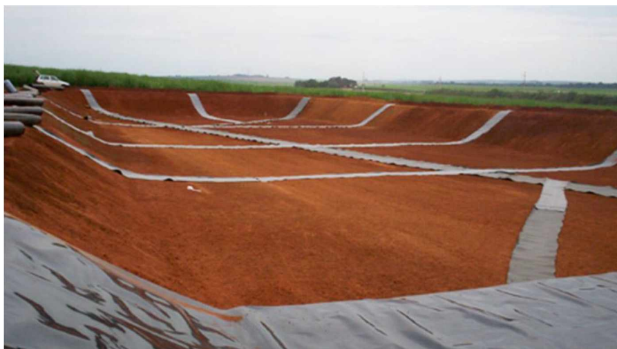
Figura 3: Tanque impermeabilizado para armazenamento de vinhaça.
