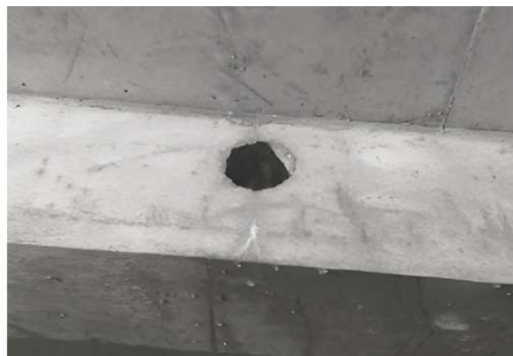
Figura 28: Fissuração por recalque em seção enfraquecida por furo (THOMAZ, 2021)
