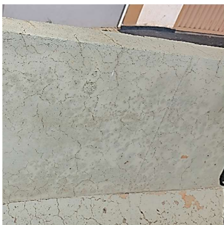
Figura 44: Fissuras mapeadas nos guarda-corpos (AUTOR)
