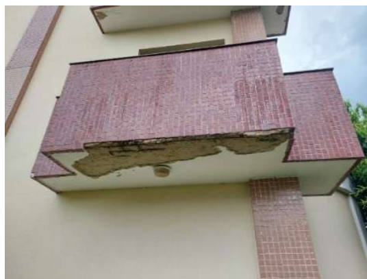
Figura 3: Processo de corrosão de armaduras em edifício de Uberlândia - MG (Acervo Próprio, 2025)
