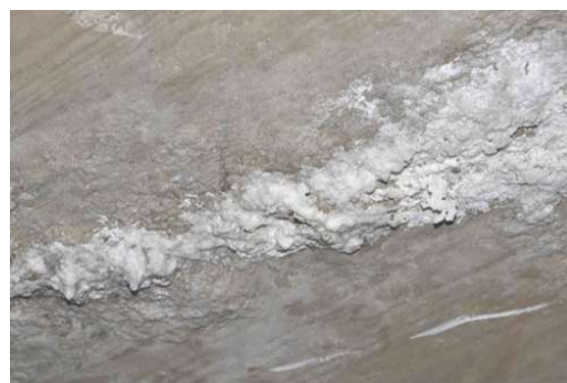
Figura 32: Eflorescências em estrutura de concreto (3H Impermeabilização, 2020)
