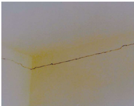
Figura 5: Comportamento de fissuras resultantes do abaulamento e dilatação de laje de cobertura (HELENE; TUTIKIAN; BOLINA, 2019)
