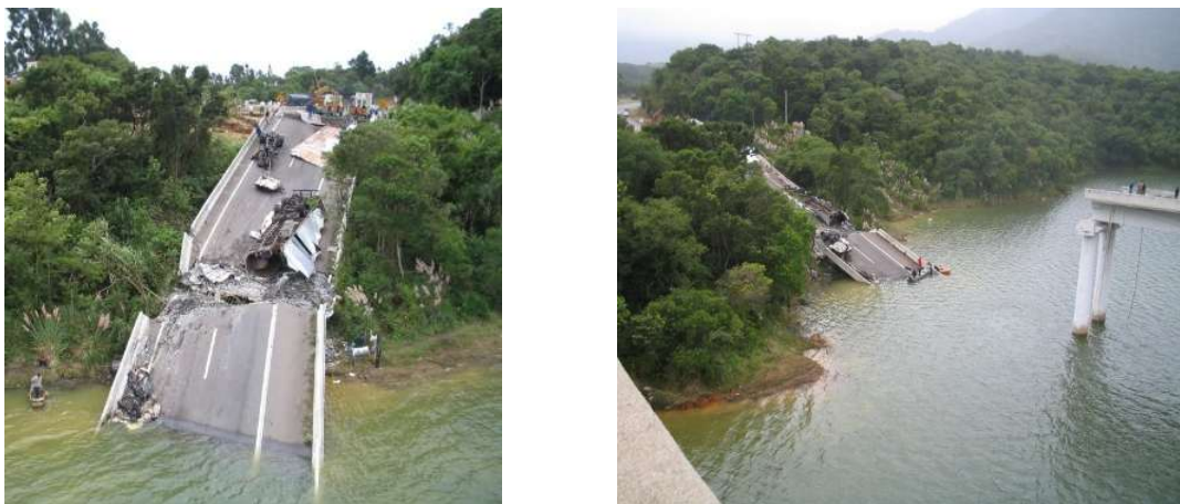
Figura 33 (A e B): Desabamento da Ponte sobre a Represa do Rio Capivari (CENACID, 2005)
