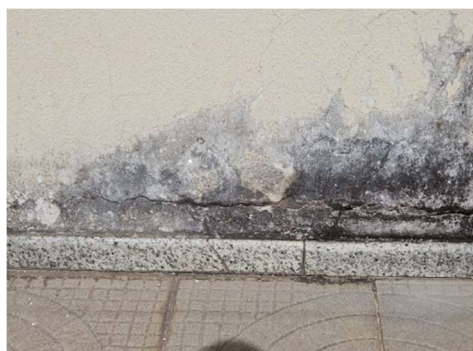
Figura 31: Eflorescência por processo de lixiviação em parede fissura com mofo (Acervo Próprio, 2025)
