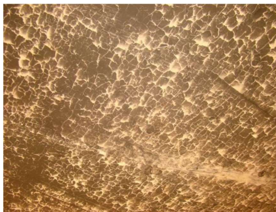
Figura 11: Concreto pós-incêndio fissurado com acúmulo de fuligem (SOLERO; SANTOS, 2015)
