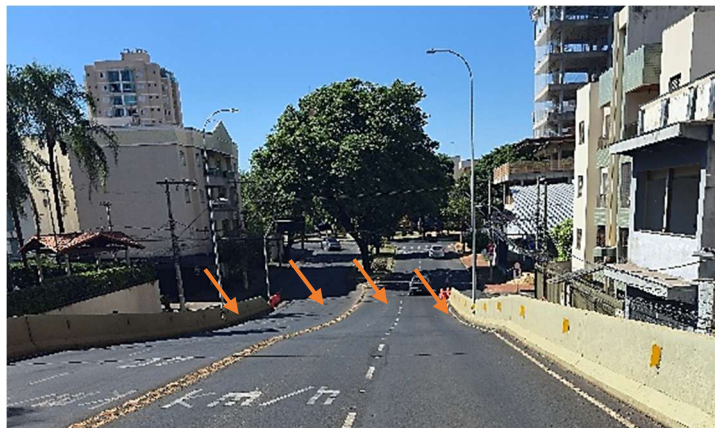
Figura 39: Abaulamento das pistas de rolamento na Rampa 7 devido a flechas excessivas das vigas longarinas (AUTOR)
