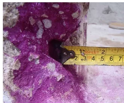
(c) Ensaio de carbonatação com fenolftaleína
