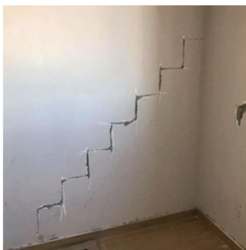
Figura 6: Trinca devido a esforços de cisalhamento da dilatação de uma laje de cobertura - rompimento destacado na argamassa (HELENE; TUTIKIAN; BOLINA, 2019)
