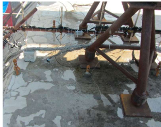
Figura 10: Fissuração e fuga de água da peça de concreto com 58 minutos de ensaio (DUAN et al. , 2023)
