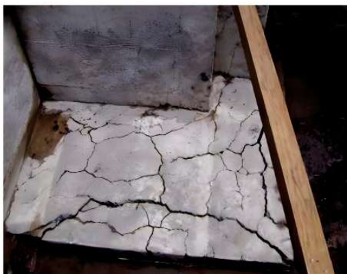
Figura 30: Bloco de fundação com fissuras por RAA (GOMES e OLIVEIRA, 2009 apud THOMAZ, 2021)
