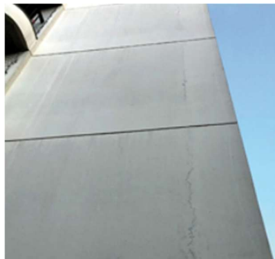
Figura 7: Destacamento de alvenaria com estrutura reticulada por movimentações térmicas distintas (HELENE; TUTIKIAN; BOLINA, 2019)
