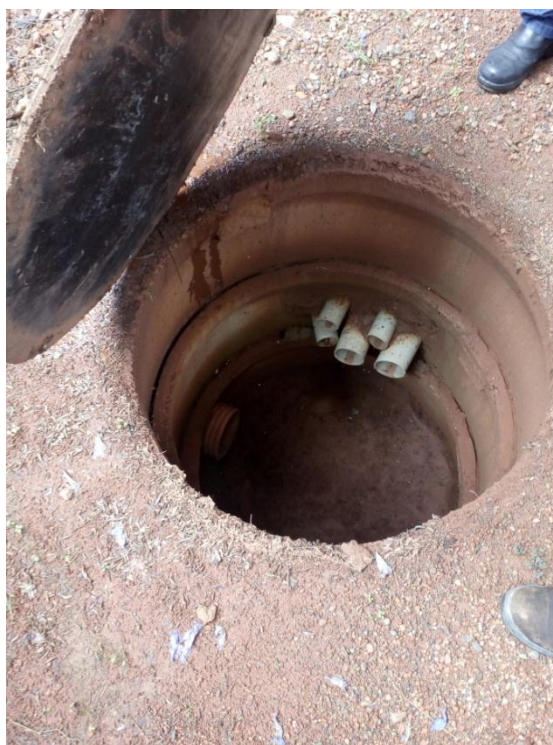
Figura 15 - Concretos de PV instalados para a separação de água pluvial com esgoto.
