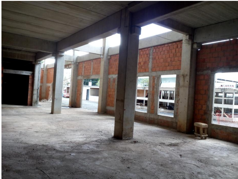
Figura 11 - Entrada do hospital, hiperventilada.
