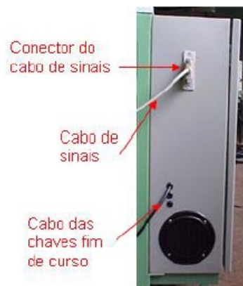
Figura 24 - Vista lateral do quadro de comando
