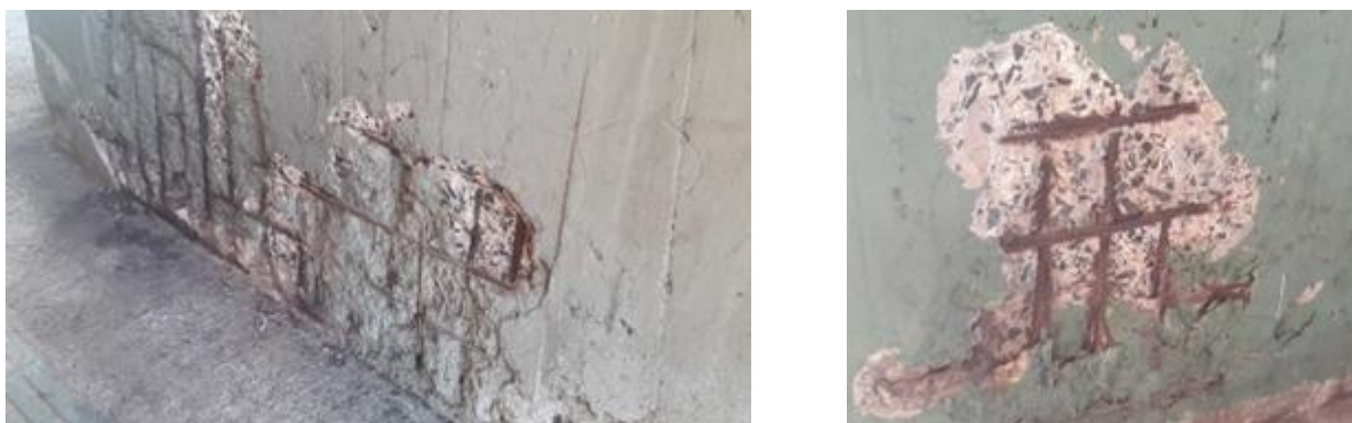
Figura 31 - Corrosão das barras de aço de um dos pilares do viaduto.
