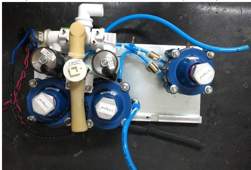
Figura 11: Compartimento das válvulas de ar liberado por completo do ventilador
