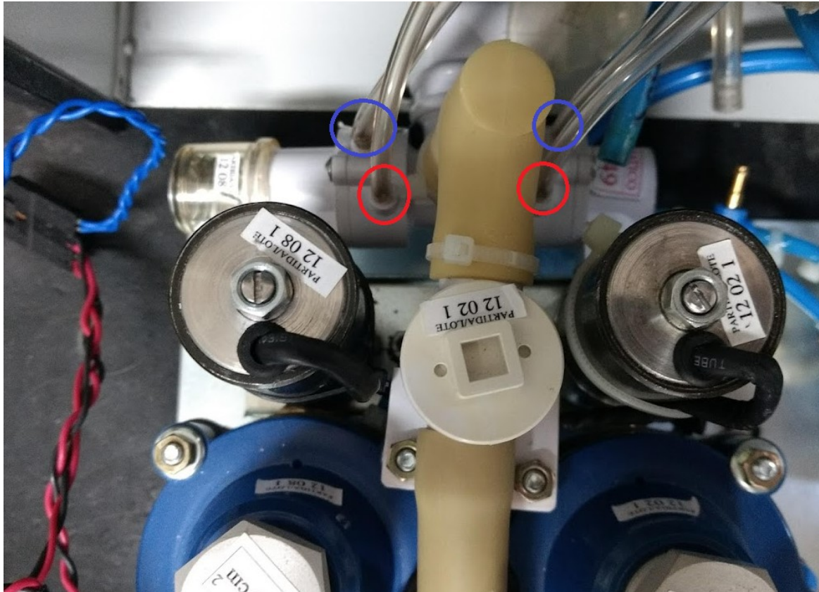
Figura 18: Conexão das mangueiras negativas e positivas de ar e oxigênio
