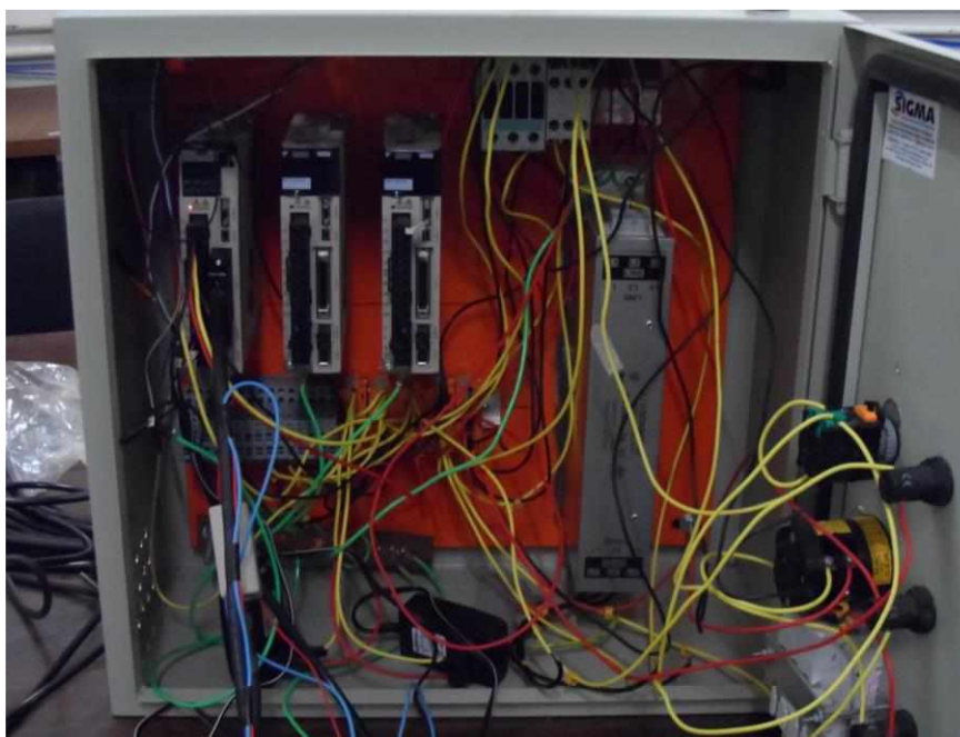
Figura 4.12 – Painel elétrico de potência e controle dos servomotores (DA SILVA, 2013).
