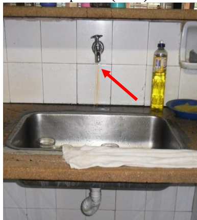
Foto 3.1 – Escola 32.2: torneira da cozinha com vazamento no ponto de inserção do cano na parede (2012)
