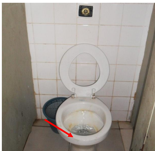
Foto 3.9 – Escola 34.5: vazamento detectado na válvula de descarga do vaso sanitário (2012)
