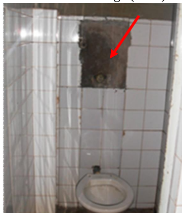
Foto 3.3 – Escola 32.2: instalação sanitária com evidência de vazamento interno na válvula de descarga (2012)
