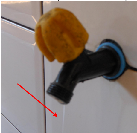
Foto 3.15 – Escola 39.10: torneira do bebedouro deixada parcialmente aberta (2012)
