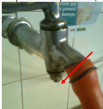
Foto 3.24 – Escola 40.9: vazamento na torneira pia da sala dos professores (2012)
