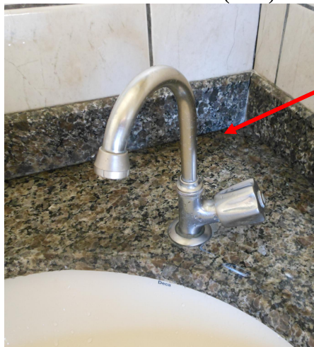
Foto 3.18 – Escola 39.10: torneira do lavatório com defeito (2012)
