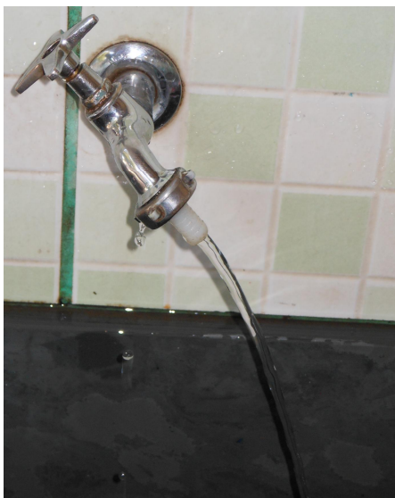
Foto 3.30 – Escola 40.40: descuido no fechamento da torneira do bebedouro (2012)
