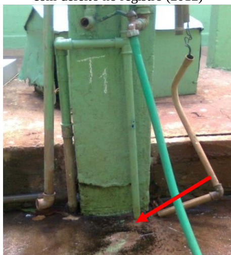
Foto 3.5 – Escola 32.10: torneira de uso geral com defeito no registro (2012)
