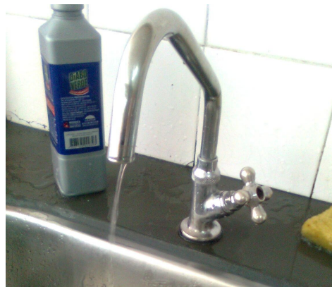
Foto 3.27 – Escola 40.9: descuido ao fechar a torneira da cozinha (2012)
