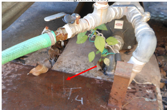
Foto 3.23 – Escola 39.14: vazamento na conexão entre a torneira da bomba d'água e a mangueira (2012)
