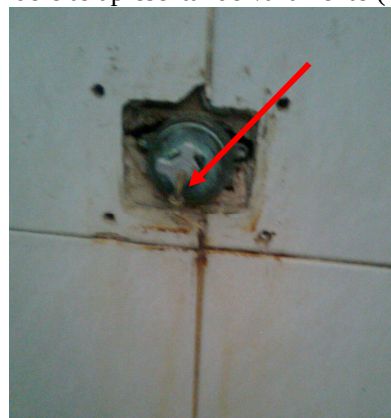
Foto 3.25 – Escola 40.9: válvula de descarga com defeito apresentando vazamento (2012)
