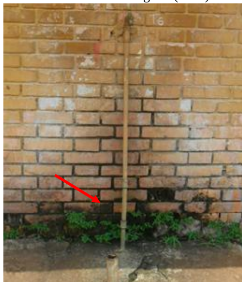
Foto 3.12 – Escola 18.24: vazamento detectado na torneira de uso geral (2012)
