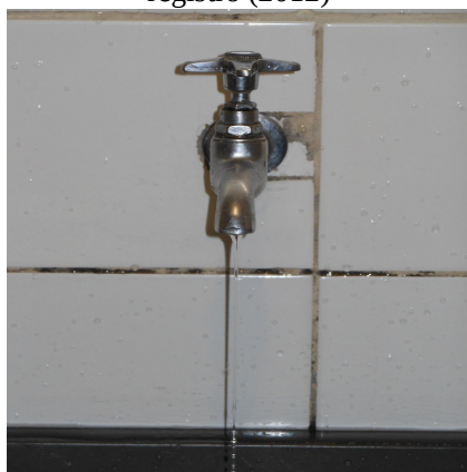
Foto 3.28 – Escola 40.40: torneira com defeito no registro (2012)
