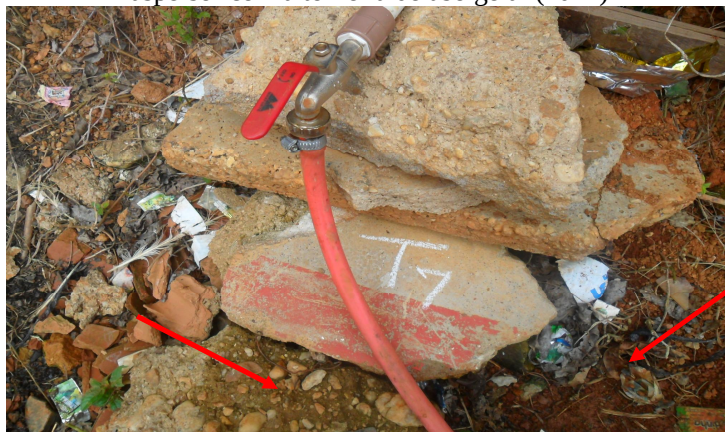
Foto 3.14 – Escola 43.7: vazamento na conexão da mangueira do aspersor com a torneira de uso geral (2012)
