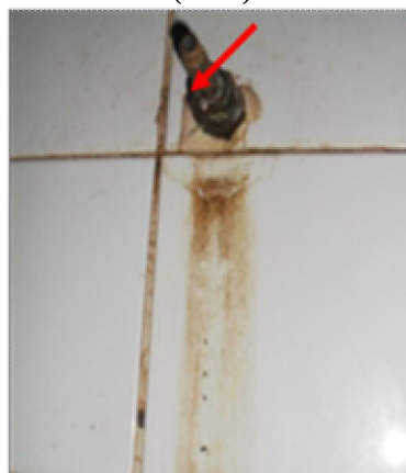
Foto 3.2 – Escola 32.2: vazamento detectado no registro de gaveta do banheiro masculino (2012)
