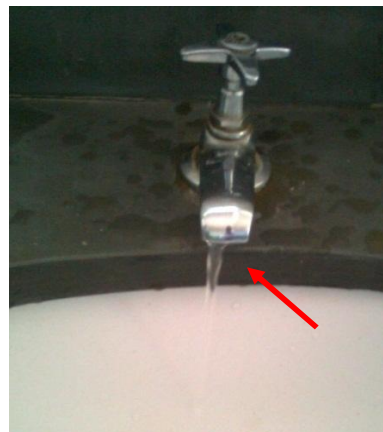
Foto 3.4 – Escola 32.10: torneira do lavatório com defeito no registro (2012)
