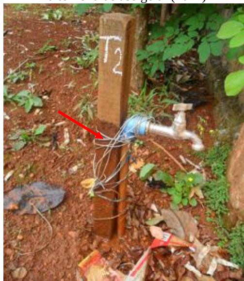
Foto 3.11 – Escola 18.24: vazamento detectado na torneira de uso geral (2012)
