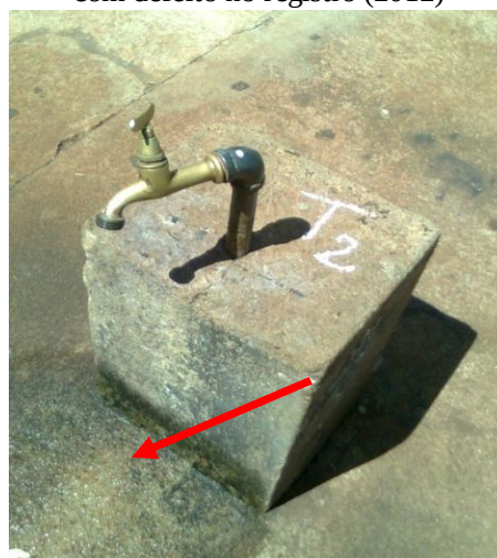
Foto 3.6 – Escola 32.10: torneira de uso geral com defeito no registro (2012)
