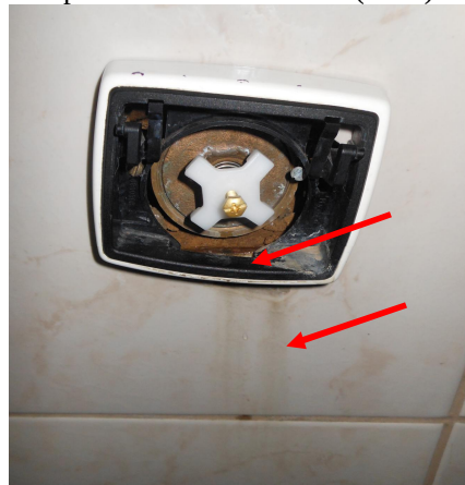
Foto 3.16 – Escola 39.10: válvula de descarga apresentando vazamento (2012)
