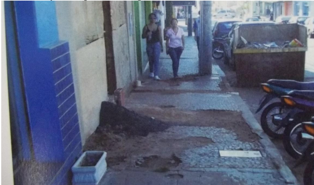
Foto 02: Calçadas irregulares em Araguari. 2010.
