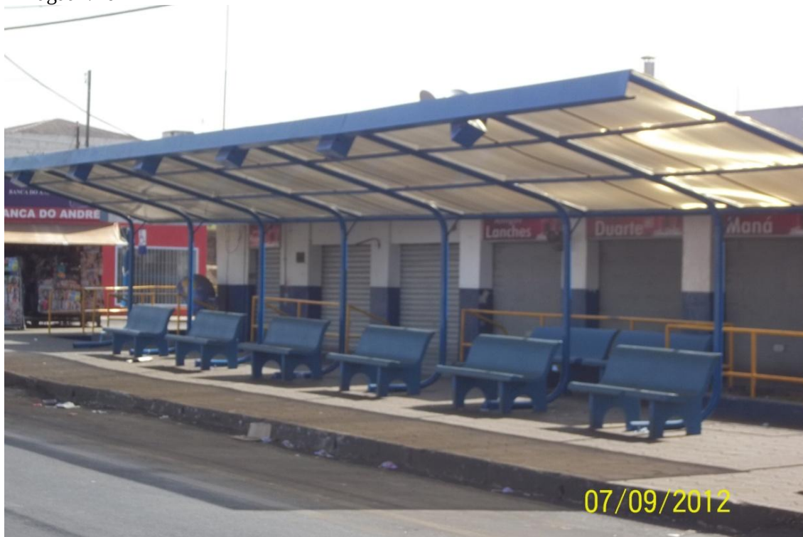
Foto 08: Estrutura de ferro ponto de ônibus avenida coronel teodolino pereira de aráujo – Araguari/2012
