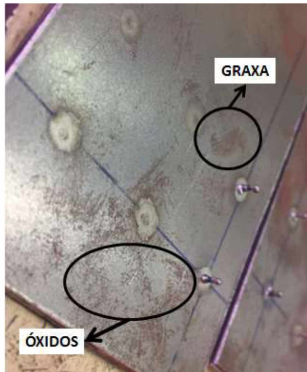
Figura 28 – Pinos com solda enfraquecida se soltaram da superfície. Destaque para a presença de óxidos na chapa.
