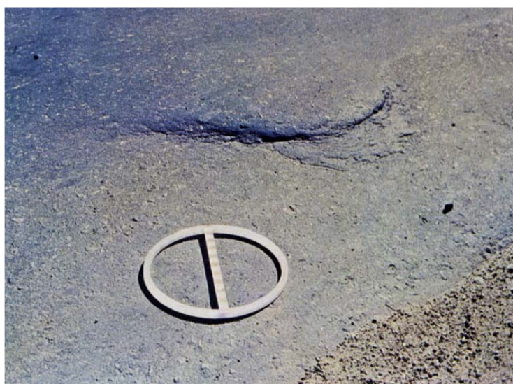
Figura 15 - Exemplo de Escorregamento
