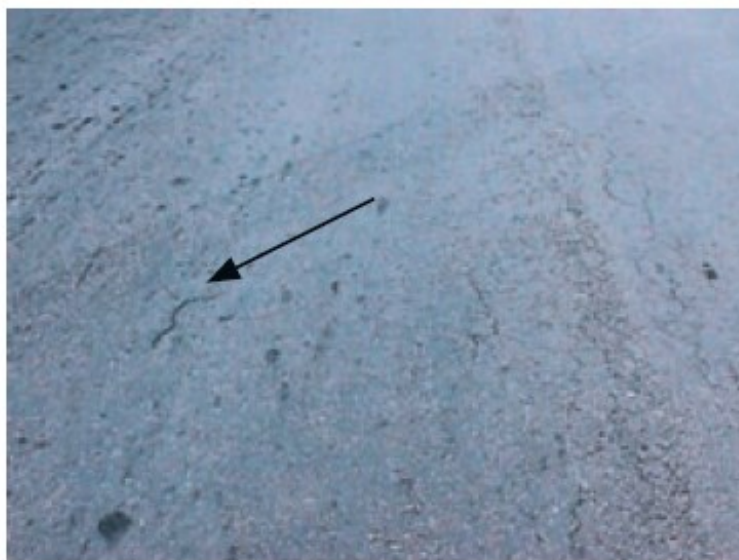
Figura 6 - Exemplo de Trinca Isolada Longitudinal Curta
