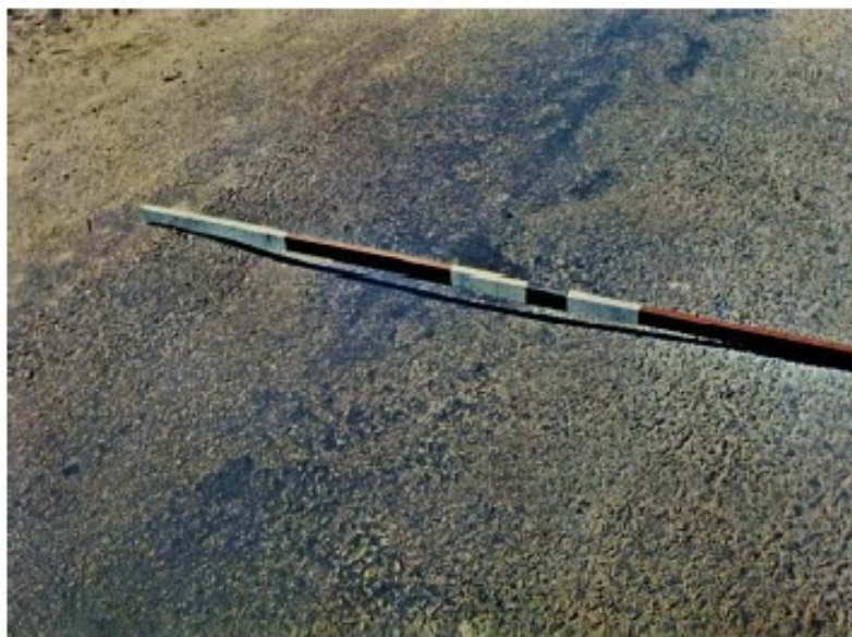
Figura 11 - Exemplo de afundamento plástico local
