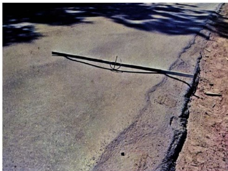
Figura 12 - Exemplo de Afundamento plástico da trilha de roda
