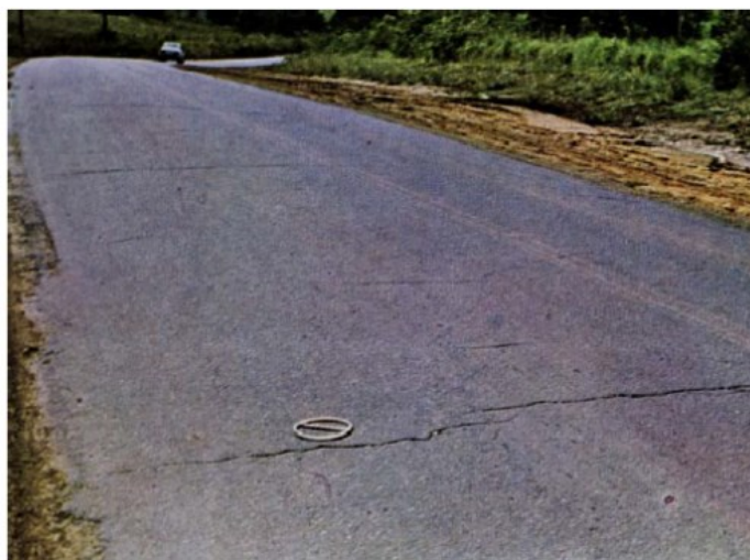
Figura 5 - Exemplo de Trinca Isolada Transversal Longa
