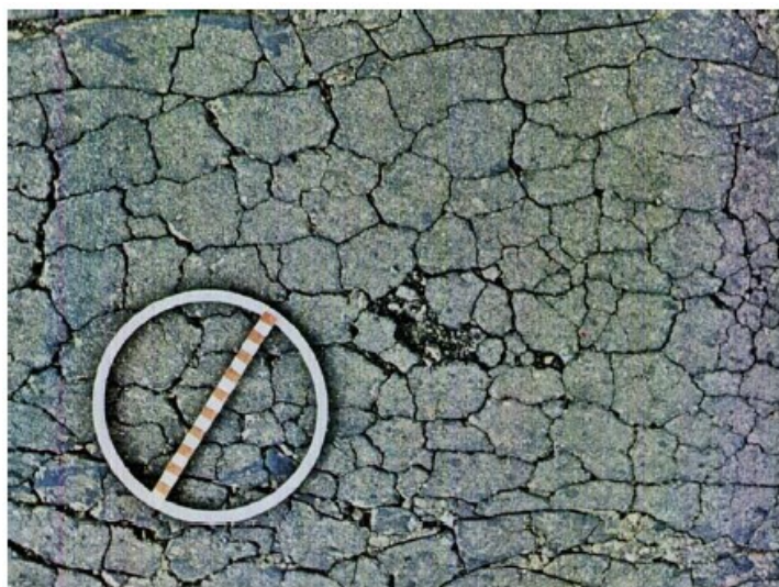
Figura 9 - Exemplo de Trincas Interligadas tipo Couro de Jacaré
