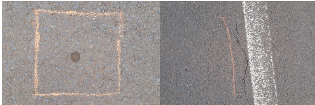
Figura 34 - Exemplos de demarcação dos defeitos com uso de giz
