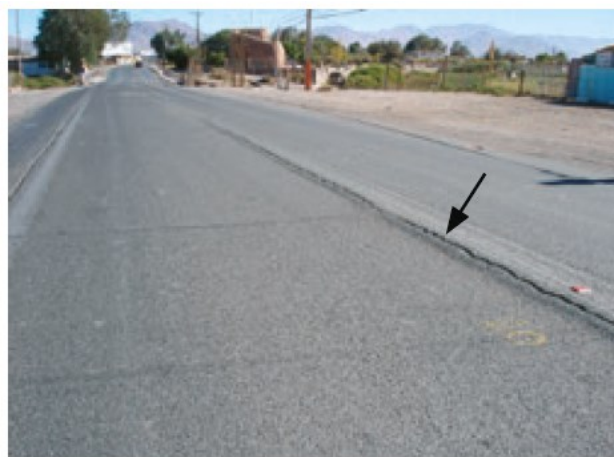
Figura 8- Exemplo de Trinca Isolada de Retração (TRR)
