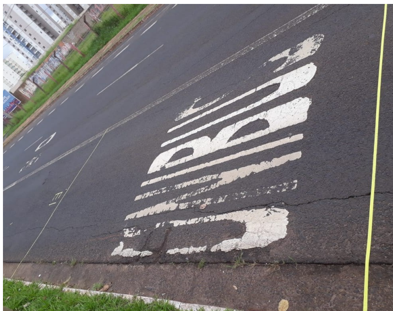
Figura 39 - Estação 13 (Possui maior incidência de defeitos)
