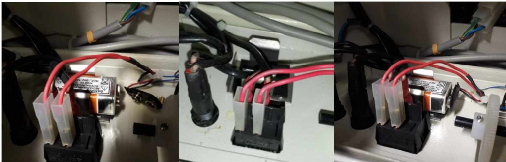
Figura 15 - Bateria de 9V sendo substituída.
