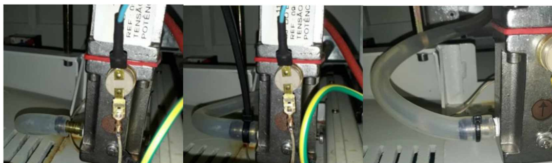
Figura 19 – Mangueira de silicone sendo reconectada.
