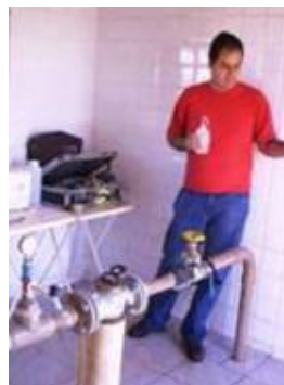
Poço 2: Técnico do LAMIN/CPRM
