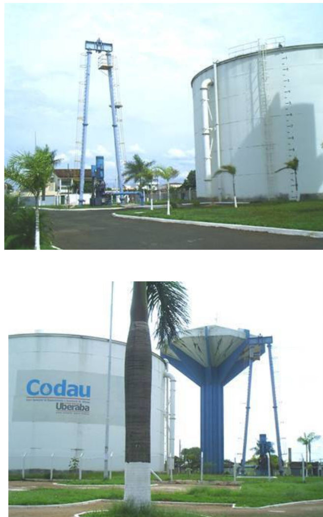
Figura 4-7: Fotos do conjunto elevatório do poço R10
