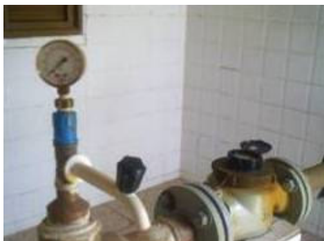
Poço 3: Manômetro, hidrômetro e torneira
