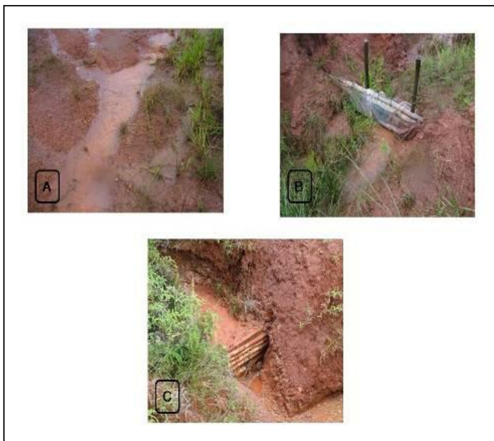
Figura 18 - (A); (B)– Imagem ilustrativa da eficiência da técnica conservacionista após ocorrência de chuva em voçoroca secundária vizinha à área de estudo; (C) – Área à jusante com demonstração do material retido na barreira de bamboo (antes de escorar com saco de terra).
