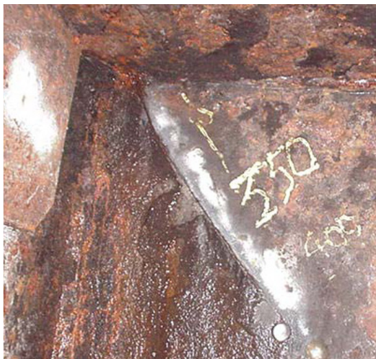
Figura 1.1: Trinca em tanque de armazenamento de um FPSO da PETROBRAS (SOUZA, 2006).
