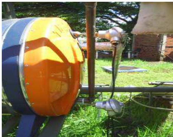
(a) Termopares instalados no boiler convencional.
