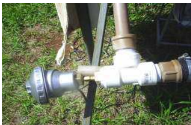
(c) termopar instalado no coletor solar.
