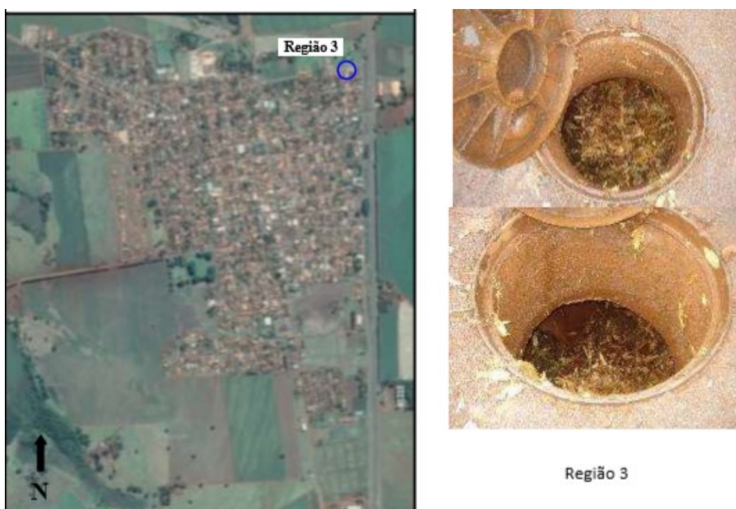
Figura 15 – Localização e situação de acúmulo de folhas nas galerias
