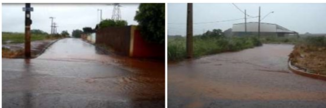
Figura 10 – a e b: Sarjetão na área urbana de Centralina
