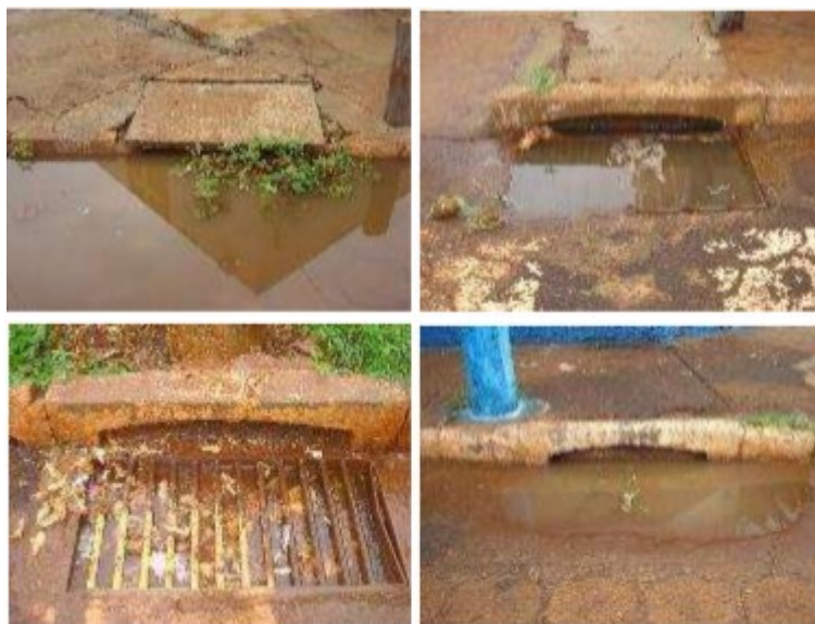
Figura 12 - Problemas de entupimento de boca de lobo
