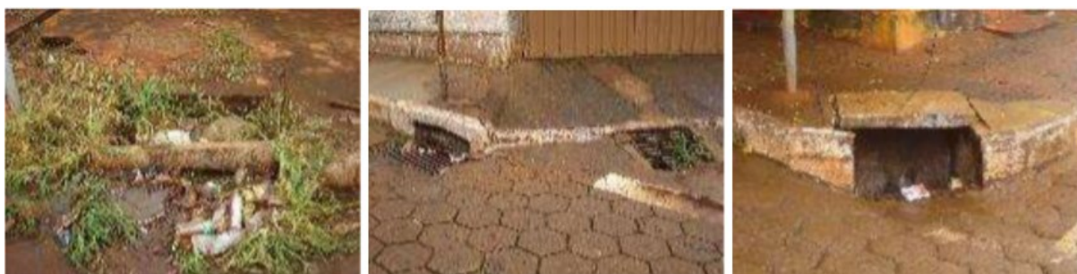
Figura 13 - Bocas de lobo danificadas
