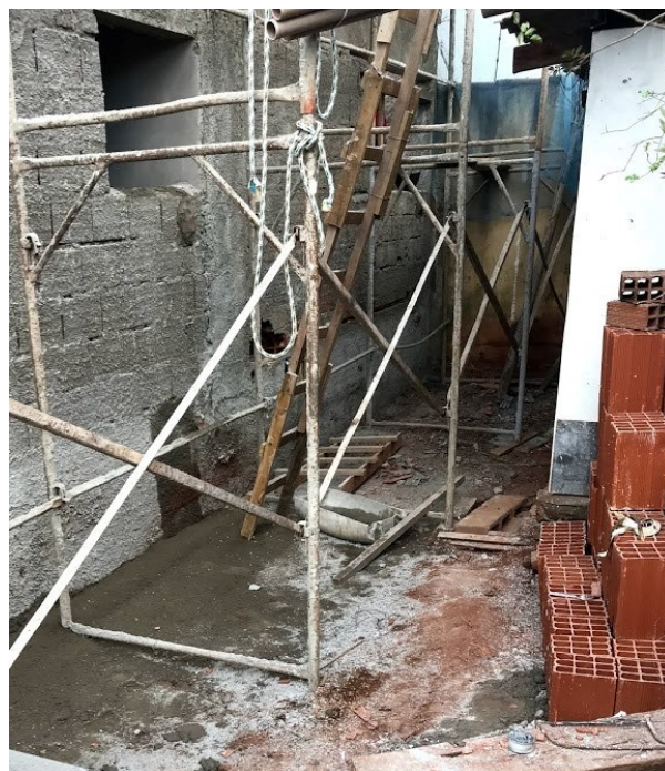
Figura 11 Escada incorretamente posicionada em baixo de andaime com risco de queda de materiais
