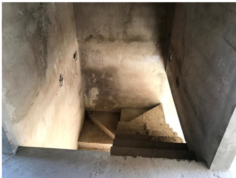
Figura 14 Piso com risco de queda sem proteção ou sinalização
