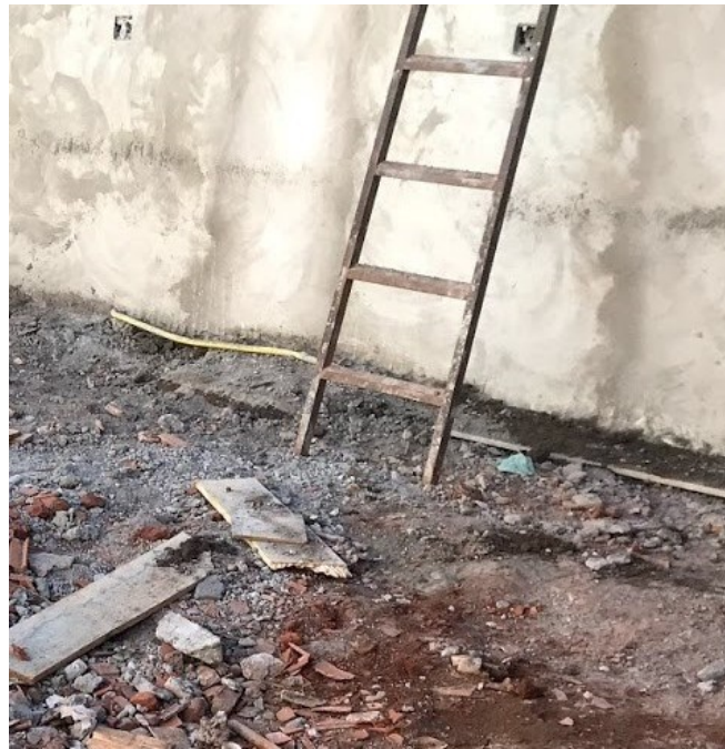
Figura 10 Escada incorretamente apoiada com risco de deslizamento
