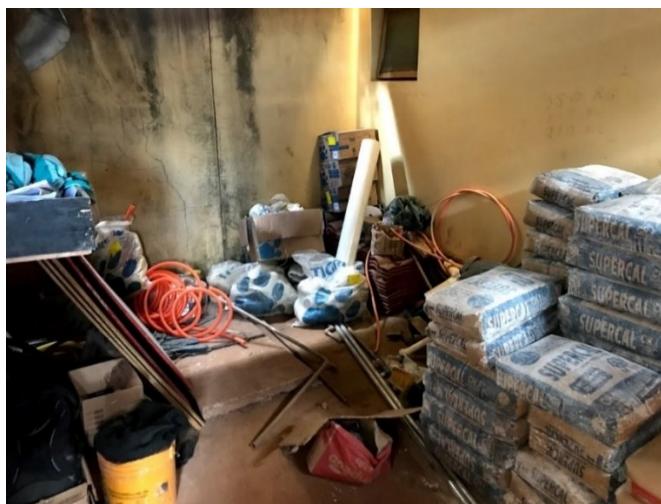
Figura 18 Almoxarifado de obra com entulhos atrapalhando circulação
