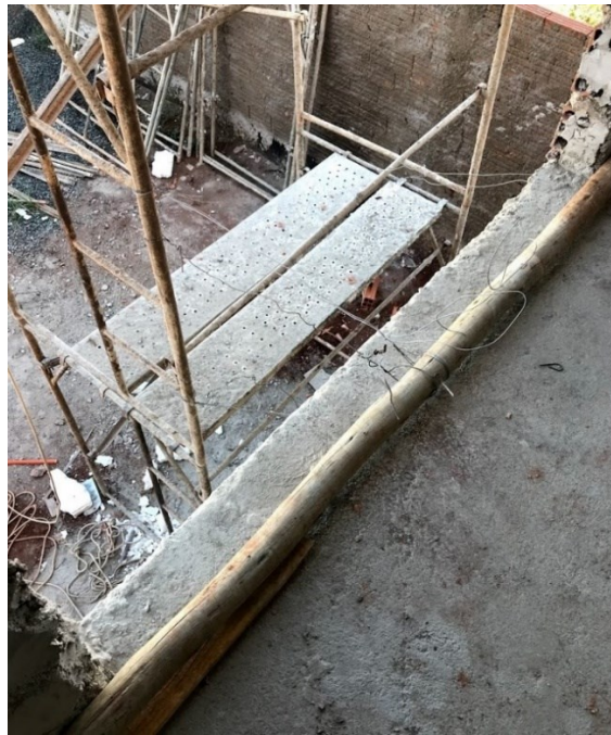
Figura 16 Andaime fixado na edificação apenas por arames e um tronco de madeira
