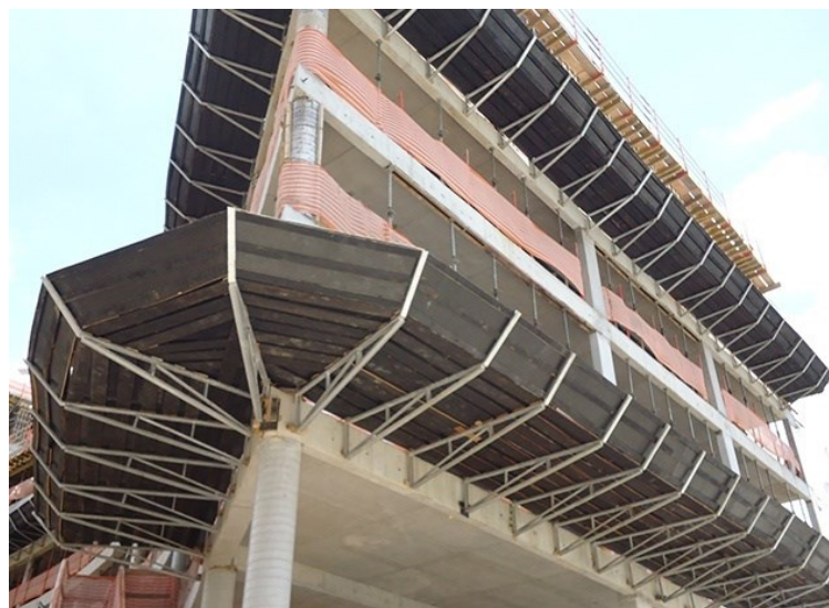
Figura 2 Plataforma de proteção para trabalhos em altura
