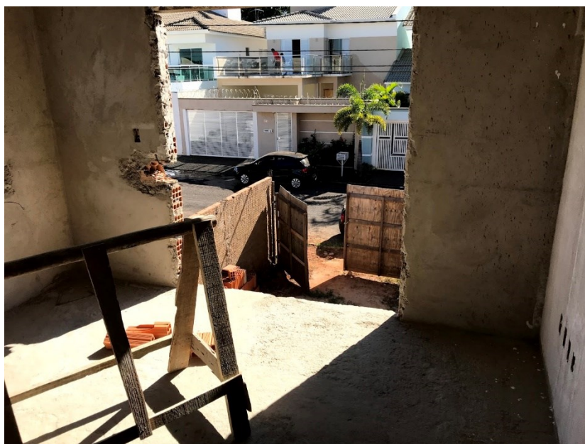
Figura 4 Perímetro da Construção sem Proteção ou sinalização contra risco de queda
