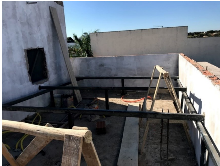
Figura 25 Má organização e disposição de itens na cobertura da obra
