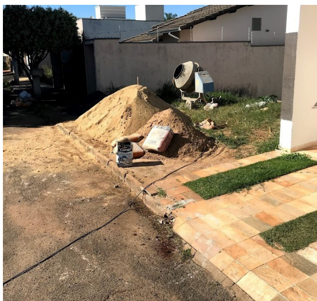
Figura 22 Depósito de materiais e maquinas de forma incorreta
