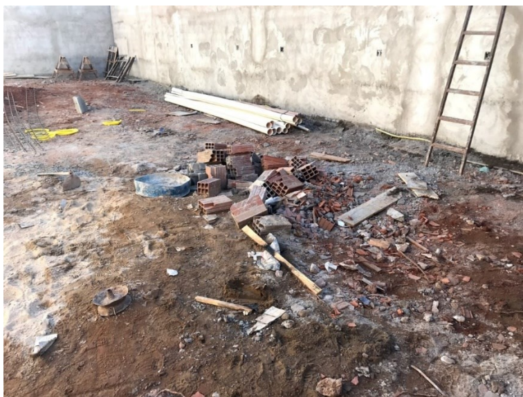
Figura 24 Entulho e lixo localizados no meio da obra
