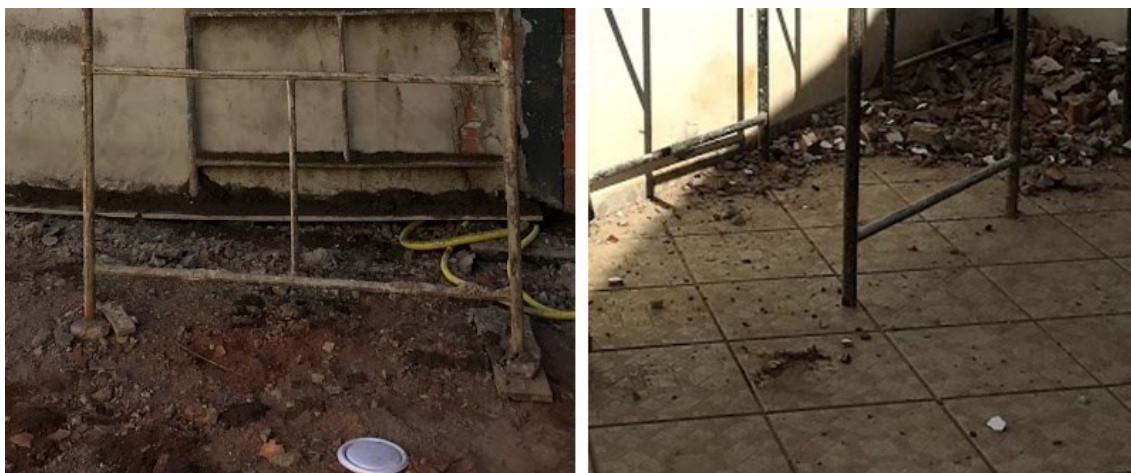
Figura 15 Andaimes ausentes de rodapés e sapatas
