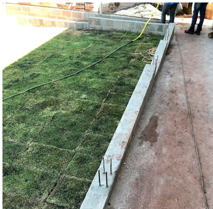
Figura 8 Pontas de vergalhões de aço expostas
