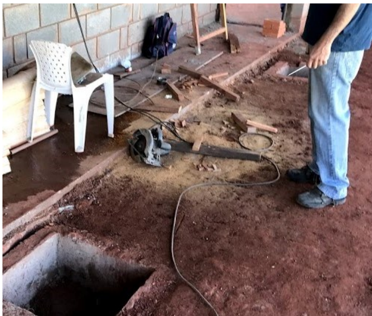
Figura 7 Serra circular incorretamente aplicada na obra
