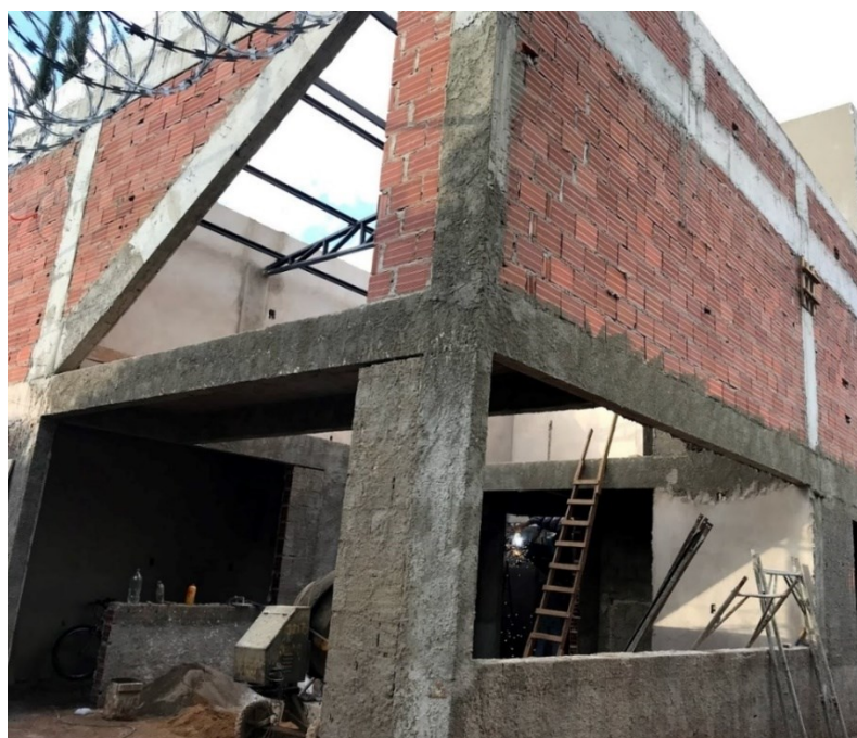
Figura 5 Abertura na estrutura com risco de queda sem proteção ou sinalização
