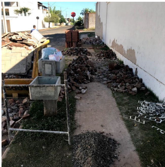
Figura 23 Entulhos de detritos da obra atrapalhando a circulação
