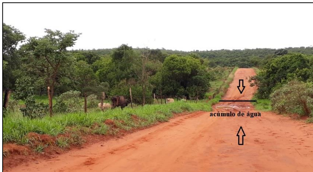
Figura 51: Acúmulo de água no ponto mais baixo da estrada onde se localiza um segmento do canal de escoamentos da Serra do Corpo Seco
