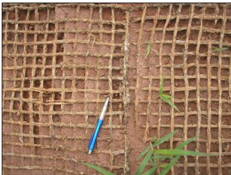
Fig. 25 – Biodegradação e acumulação de sedimentos nos geotêxteis. Autoria: BEZERRA, J.F.R, 13.12.05.
