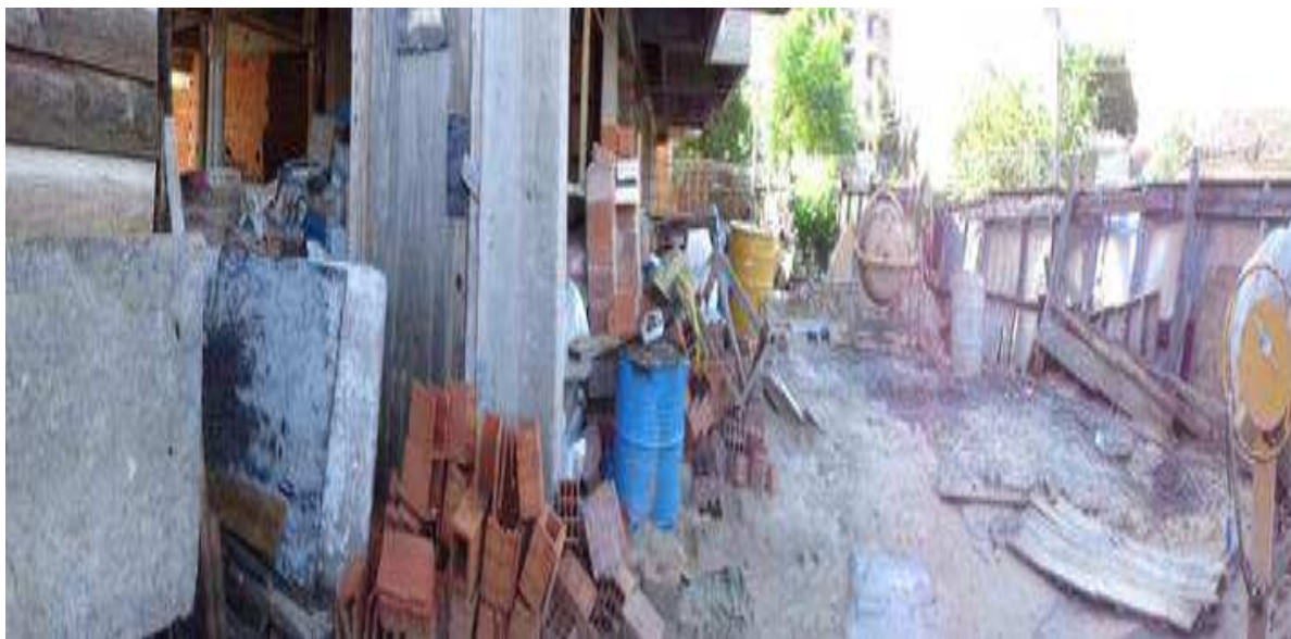
Figura 5- Canteiro de obras desorganizado.
