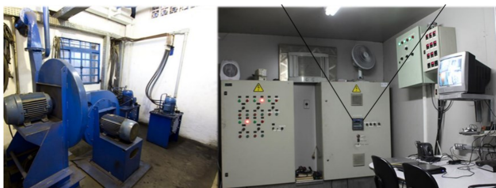
Figura 3.6 – Sistema de insuflamento (esquerda) e parte do sistema de supervisão (direita)
