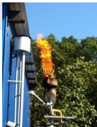
Figura 4.44 – Flare para a queima controlada do gás de síntese produzido na Planta Piloto de Mauá-SP
