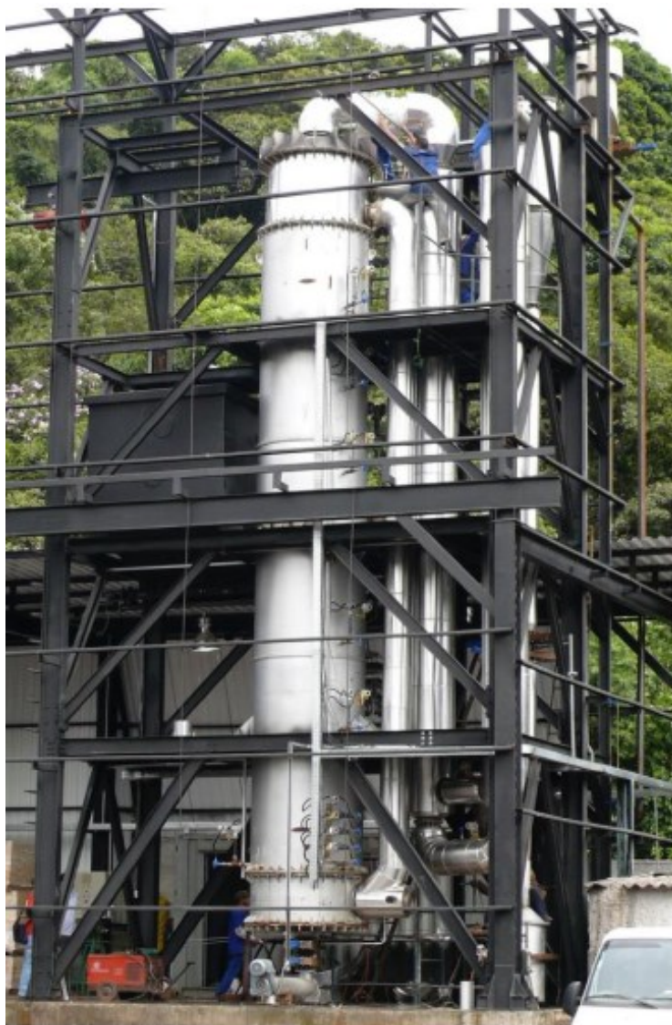
Figura 3.1 - Reator de escala semi-industrial para gaseificação de CDRSU em leito fluidizado. Planta Piloto de Mauá-SP
