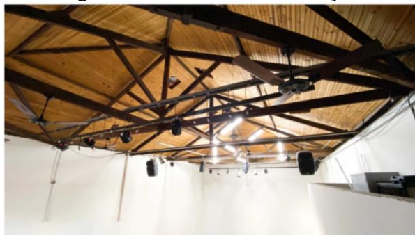
Figura 5: Estrutura de iluminação.
