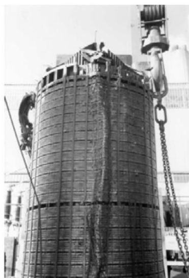
Figura 6.17: Efeito “buckling” diagnosticado no enrolamento interno BT.
