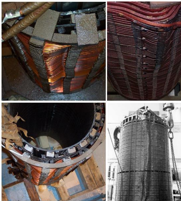
Figura 5.2: Defeito em enrolamentos devido à uma alta compressão radial causando uma saliência nos mesmos – “freebuckling”.
