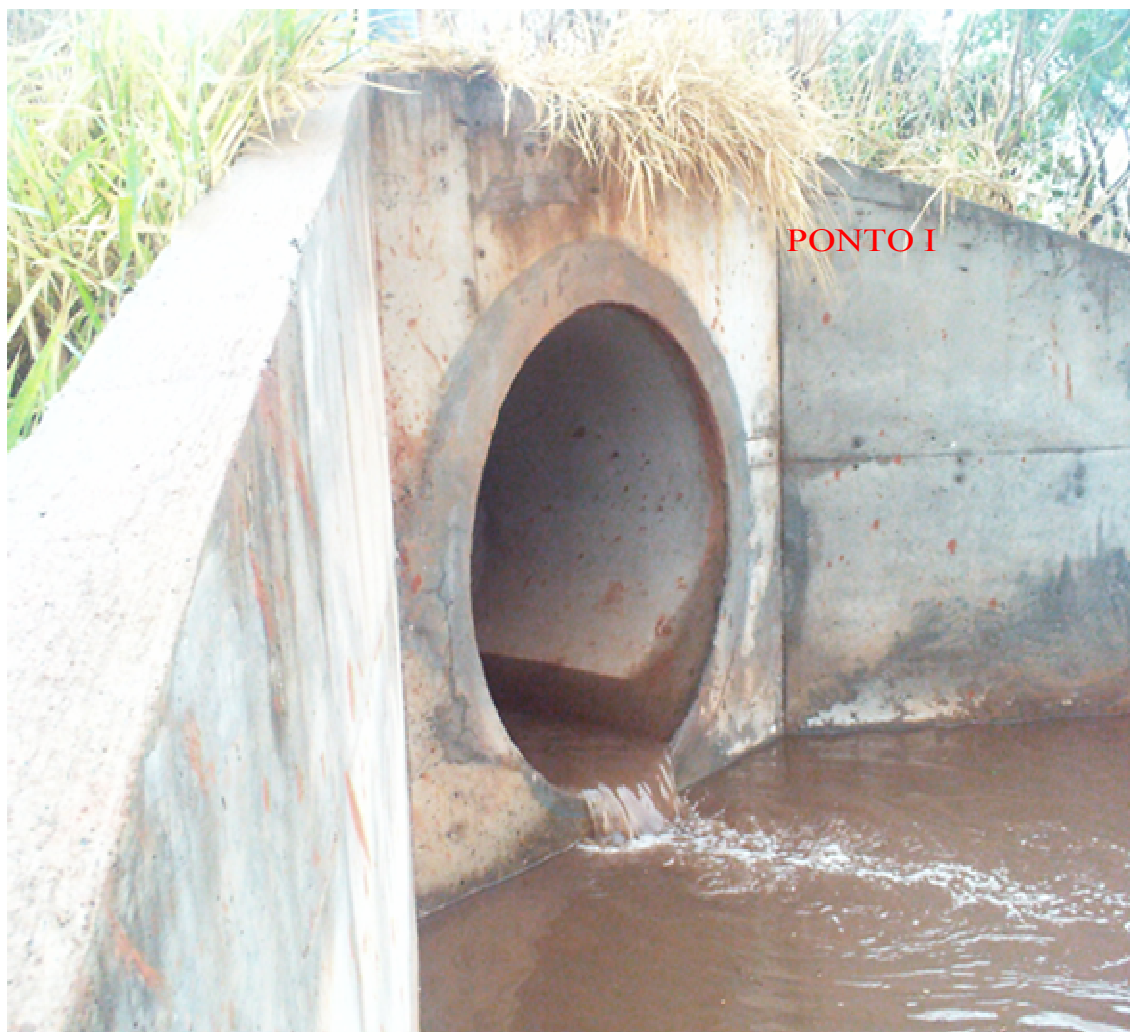
Figura 3.9 - Foto do ponto I (deságüe de uma galeria de drenagem urbana)
