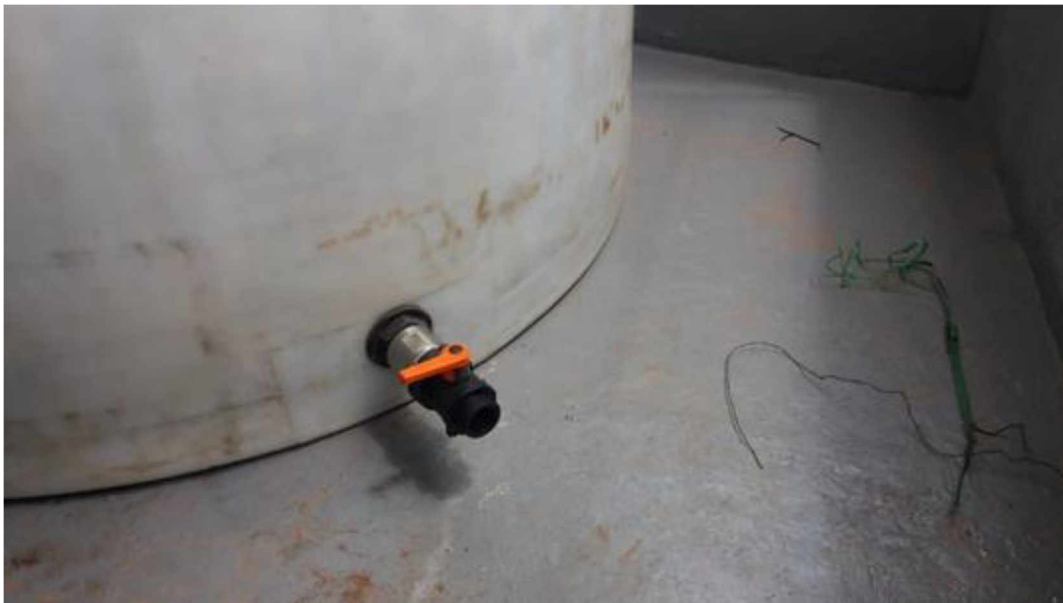
Figura 24 - Problema de derramamento na Ilha Química resolvido
