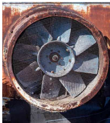
Figura 1.4 – Pá oxidada por maresia
