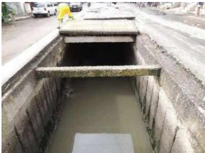
Figura 4 - Água de um canal que contém sulfatos
