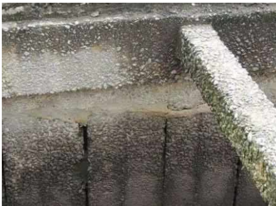
Figura 5 - Degradação do concreto por água sulfatosa
