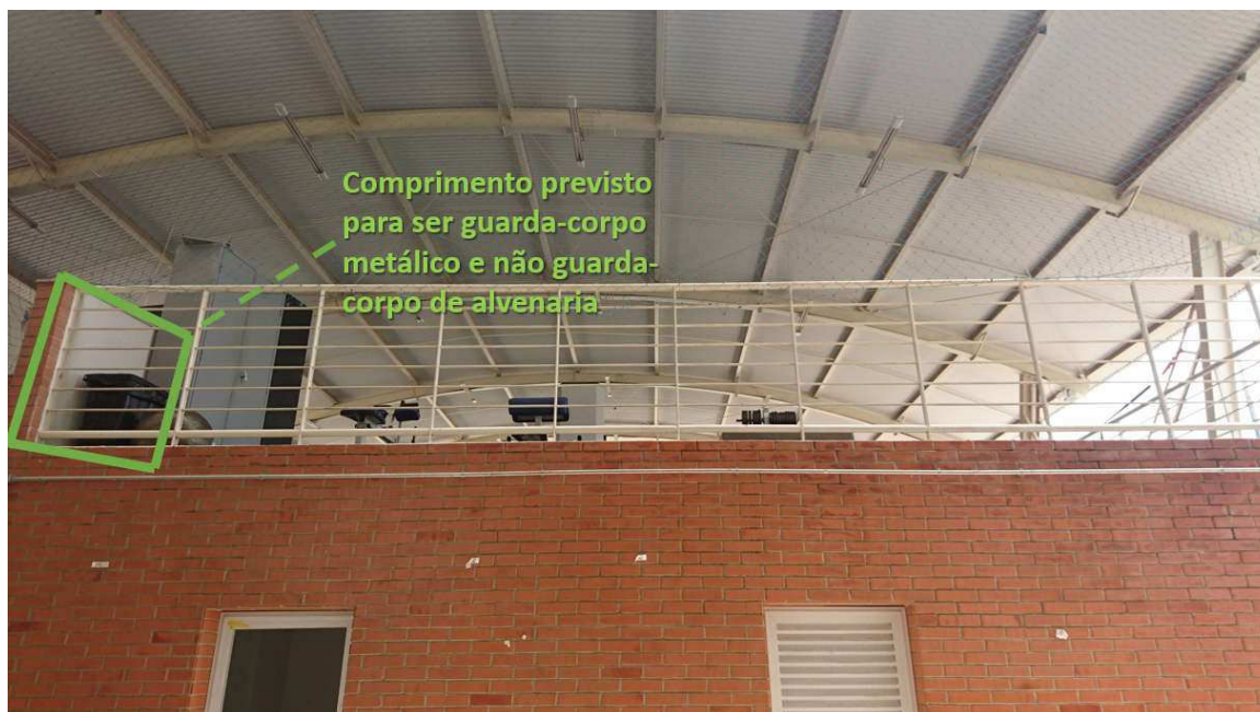
Figura 42 – Comprimento executado guarda-corpo de alvenaria ao invés de guarda-corpo metálico
