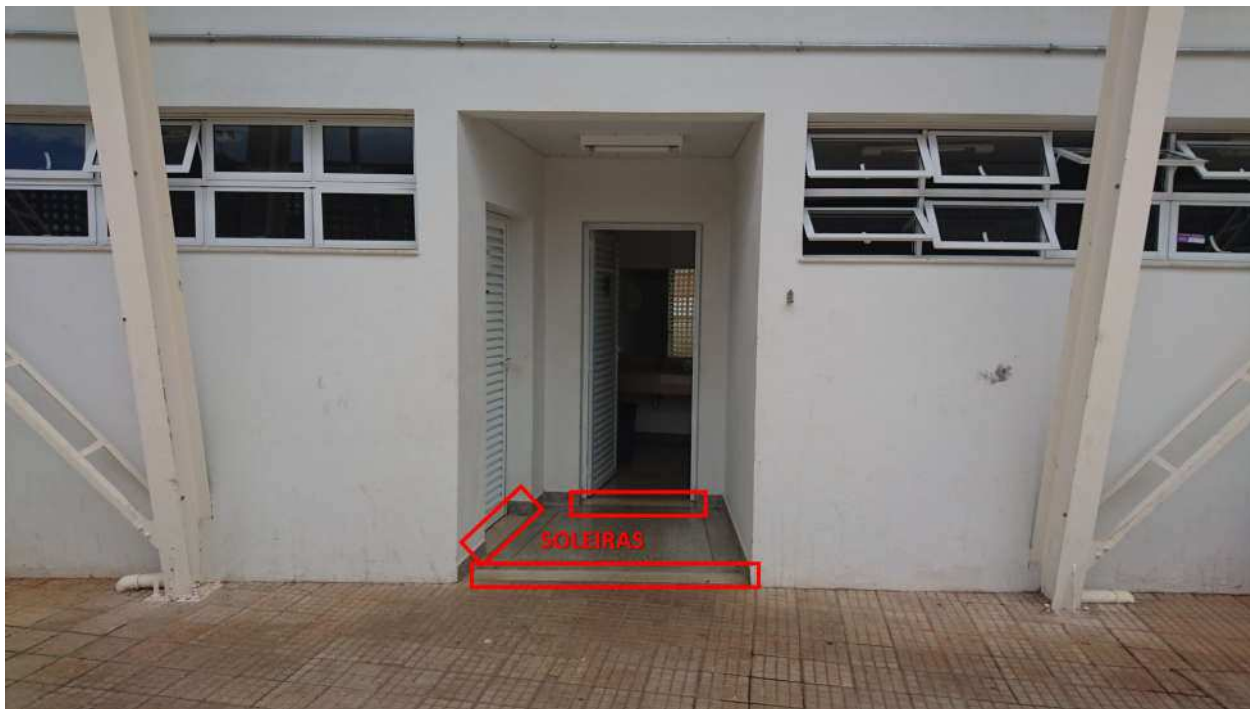
Figura 39 - Transição área externa para acesso aos vestiários com soleiras
