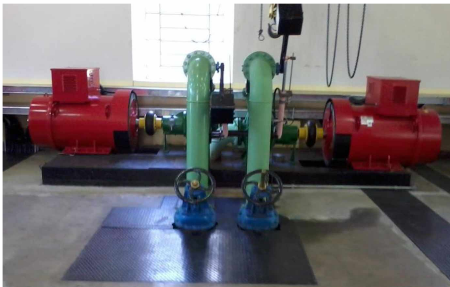
Figura 31 Vista de dois grupos geradores instalados.
