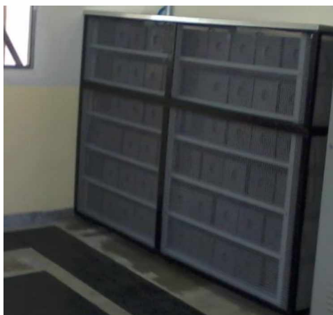
Figura 39 Banco de Baterias.
