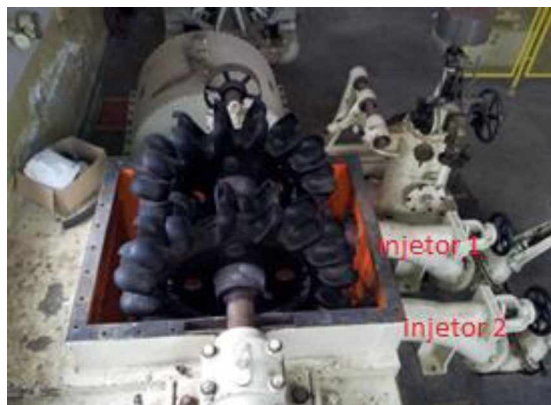
Figura 19 Antiga turbina Pelton
