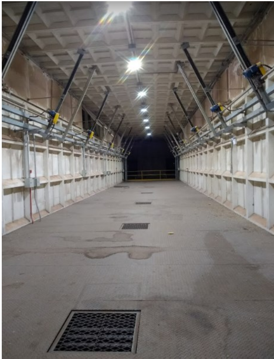
Figura 3.7 - Secador 2: Corredor por onde passa o fluxo de ar quente lançado pelos ventiladores (ao fundo)
