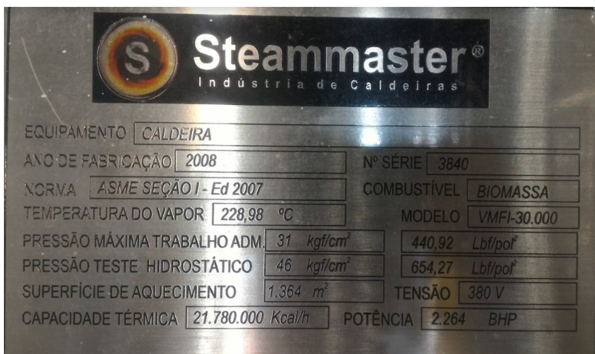
Figura 3.2 - Placa de identificação da caldeira instalada na empresa
