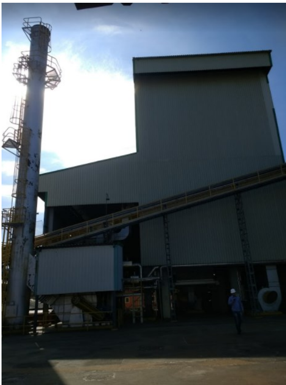
Figura 3.3 - Local onde a caldeira encontra-se instalada na empresa
