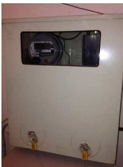
Figura 2.2 – Foto do medidor da concessionária para faturamento na cabine de entrada do Campus Santa Mônica da UFU.
